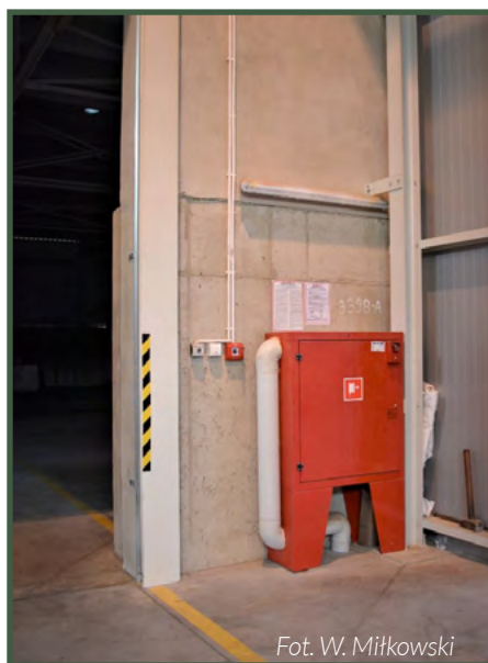
Wewnętrzny hydrant przeciwpożarowy w magazynie zbożowym z instrukcją postępowania na wypadek pożaru oraz wykazem telefonów alarmowych.
