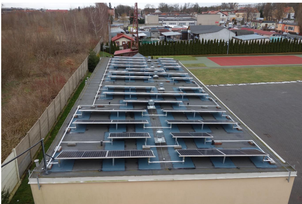
Zdjęcie - Instalacja fotowoltaiczna
