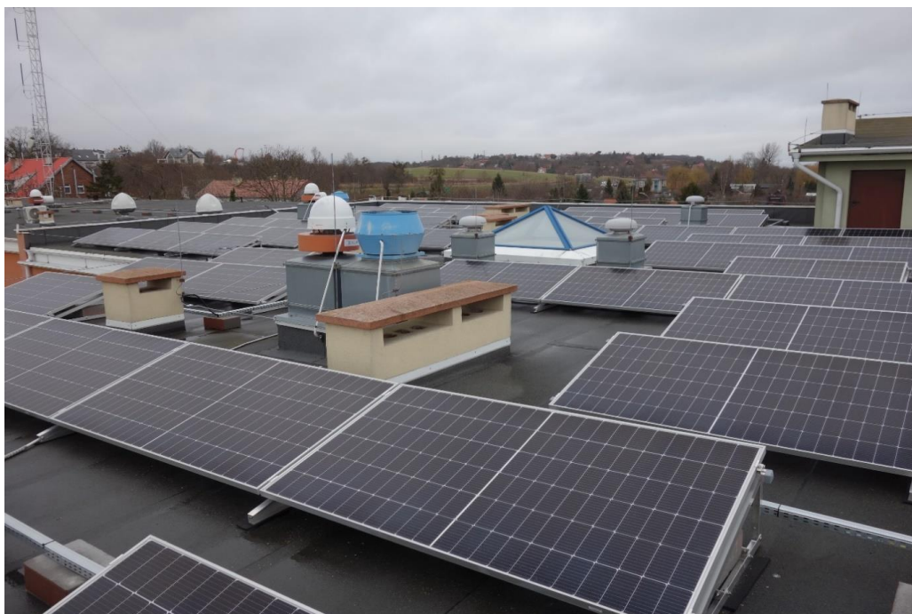
Zdjęcie - Instalacja fotowoltaiczna
