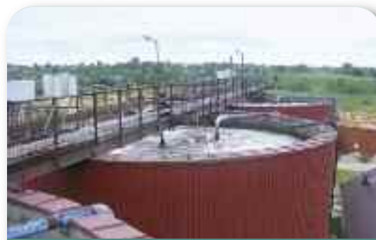
Oczyszczalnia ścieków w Olecku. Fot. Archiwum WFOŚiGW w Olsztynie.
