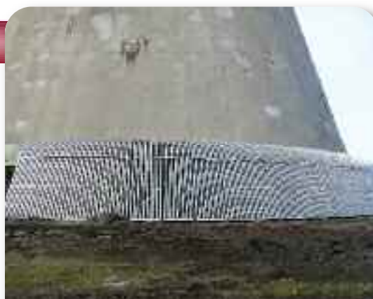
Elektrownia „Łaziska” – ekrany akustyczne na obiekcie chłodni kominowych. Fot. Archiwum Południowego Koncernu Energetycznego S.A.
