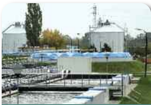
Nowo wybudowana komora denitryfikacji i nityfikacji w oczyszczalni ścieków w Grodzisku Mazowieckim. Fot. Archiwum NFOŚiGW.
