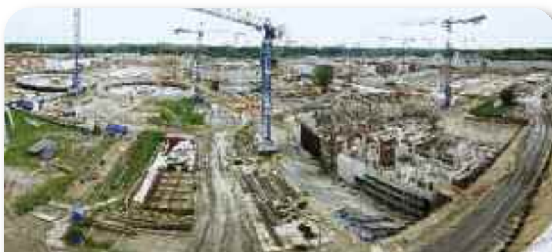
Oczyszczalnia ścieków w Warszawie. Fot. Archiwum Miejskiego Przedsiębiorstwa Wodociągów i Kanalizacji M. St. Warszawa S.A.
