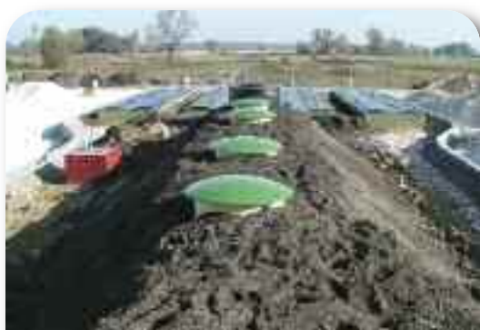
Oczyszczalnia ścieków w miejscowości Wiślica. Fot. A. Bieniaszewski.
