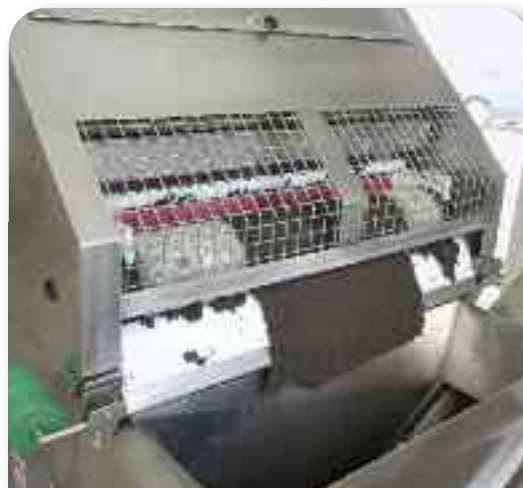
Fragment instalacji oczyszczalni ścieków w gminie Stanisławów. Fot. Andrzej Makowski; Archiwum WFOŚiGW w Warszawie.
