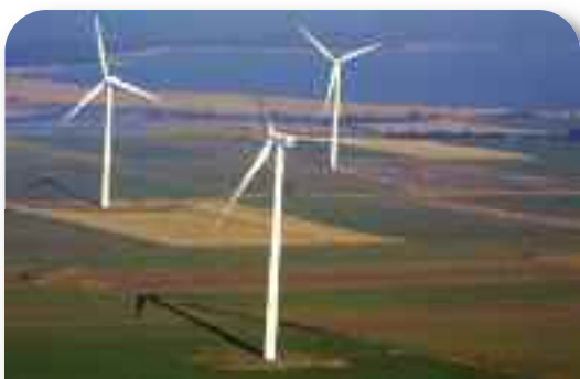
Fragment farmy wiatrowej w Tymieniu. Trzy wiatraki o łącznej mocy 6 MW.
