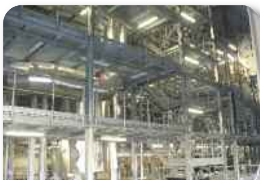
Stacja Termicznej Utylizacji Osadów w Oczyszczalni Ścieków „Płaszów II”. Fot. Archiwum WFOŚiGW w Krakowie.
