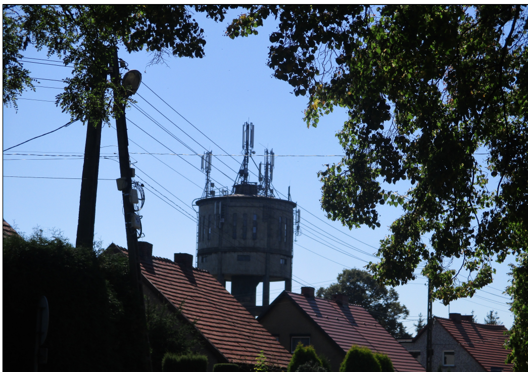
Fot. 3. Fragment instalacji radiokomunikacyjnych na wieży wodnej
