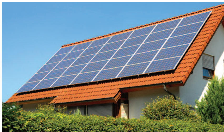
Instalacje fotowoltaiczne pracują bezgłośnie i nie emitują zanieczyszczeń – fotowoltaika jest więc idealnym rozwiązaniem dla obszarów chronionych
