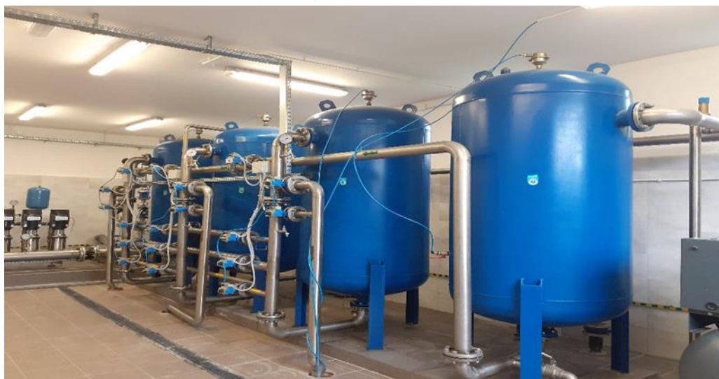
Zdjęcie 1. Stacja uzdatniania wody w Magoniach.
