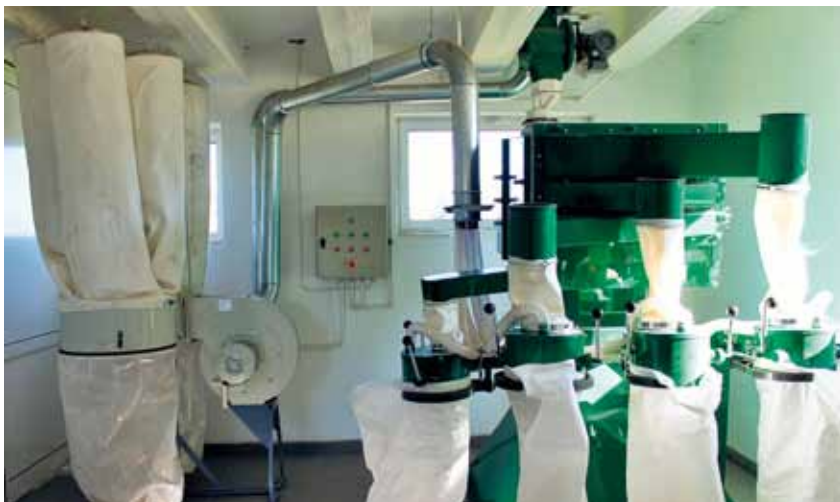
W SKŁAD MODELOWEJ LINII TECHNOLOGICZNEJ DO PRZETWÓRSTWA ZBÓŻ WCHODZI MLYN, WYPOSAŻONY WE WSZYSTKIE URZĄDZENIA NIEZBĘDNE PRZY PRODUKCJI MĄKI I KASZ Z ZIARNA PSZENICY, ŻYTA ORAZ ORKISZU ■ THE MODEL TECHNOLOGICAL LINE TO PROCESS CEREALS CONSISTS OF A MILL EQUIPPED WITH ALL DEVICES NECESSARY FOR THE PRODUCTION OF WHEAT, RYE AND SPELT FLOUR AND GROATS
