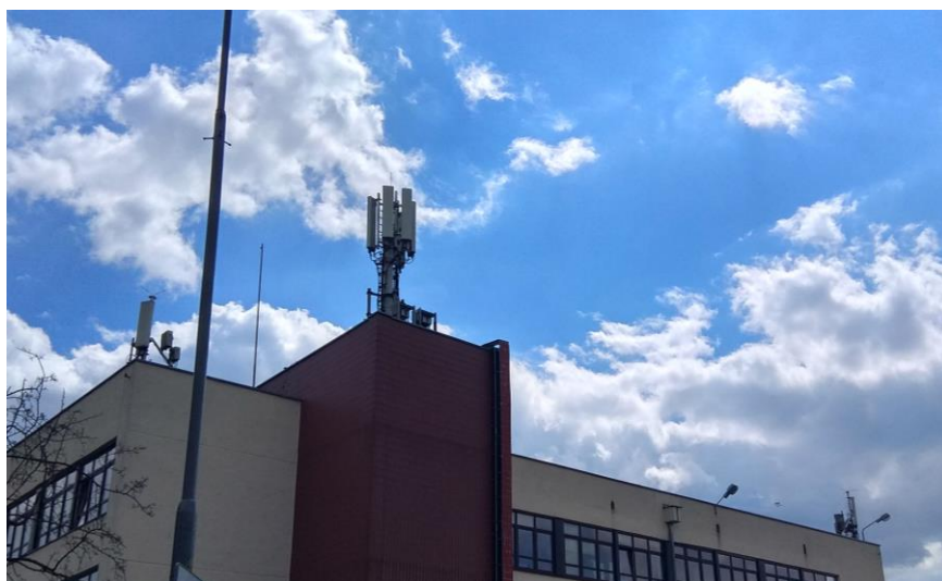
Fot. 1: Widok anten stacji bazowych: ID: POZ0134, ID: 40377 (70377N!), zlokalizowanych pod adresem: ul. Wojska Polskiego 31/33, 60-649 Poznań
