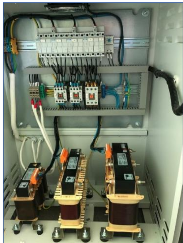
fot. 2 BMS: bateria dławikowa do kompensacji mocy biernej pojemnościowej
