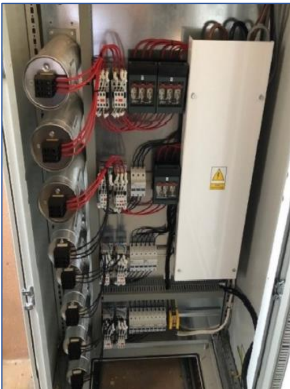
fot. 1 BMS: bateria kondensatorowa do kompensacji mocy biernej indukcyjnej
