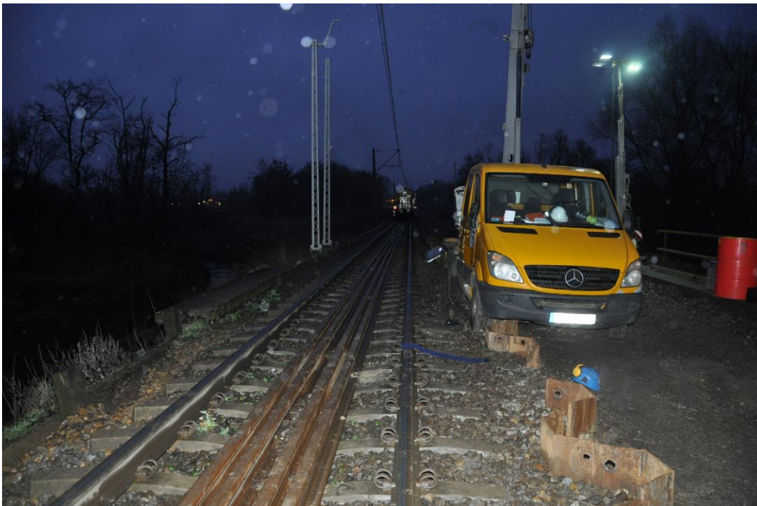
Zdjęcie 1 - Widok miejsca poważnego wypadku (źródło; materiał komisji kolejowej)
