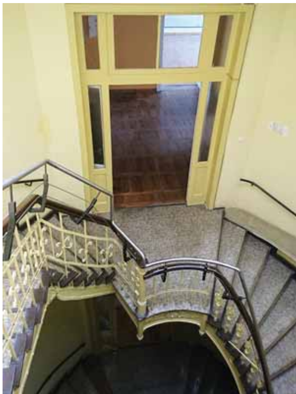
Klatka schodowa budynku nr 68 przed remontem (fot. Zenon Szklarz) i po remoncie (fot. Wojciech Drąg)
