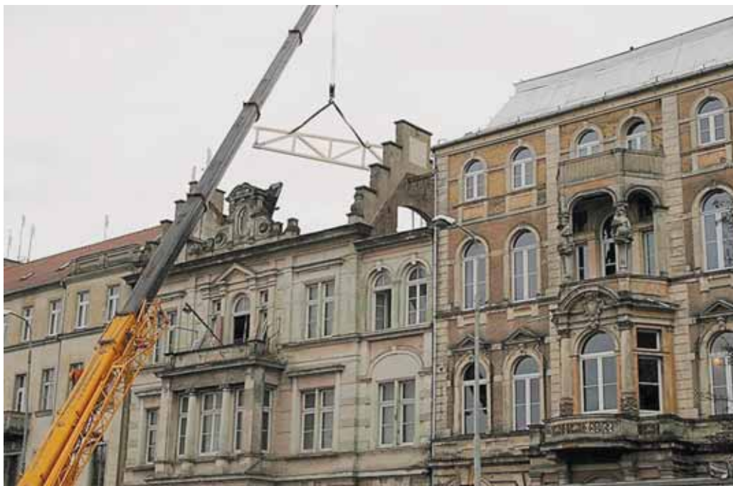
Wymiana łamanego dachu budynku nr 69 w 2014 roku. W niebo wbija się kamienny szczyt i schodkowy mur ogniowy
