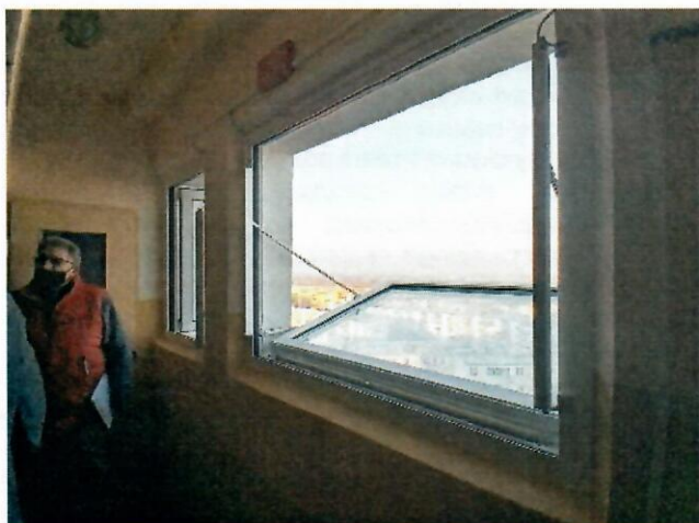
Rysunek 53 Sprawdzenie działania zamontowanej instalacji oddymiania w budynku wysokim - mieszkalnym na osiedlu Widok w Skierniewicach
