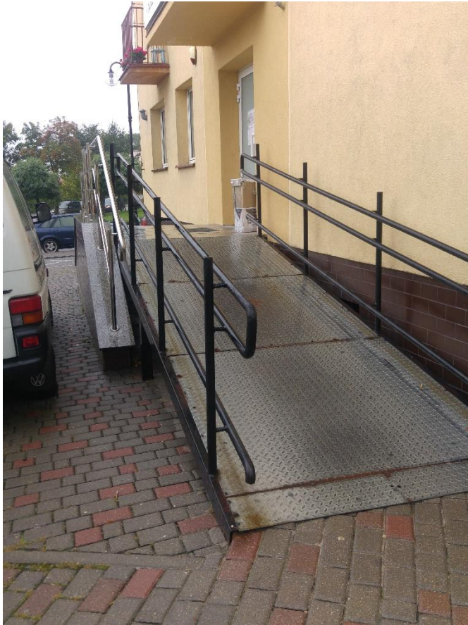
II Wejście do Biura Powiatowego ARiMR (pełniące wyłącznie funkcję wyjścia awaryjnego z siedziby)
