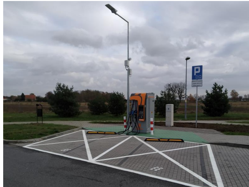
Stacja ładowania na MOP Jonas Południe
