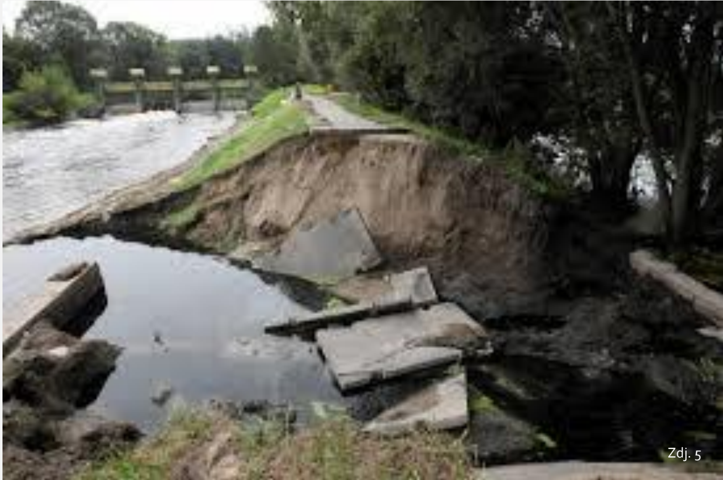
Zniszczony wał przeciwpowodziowy
