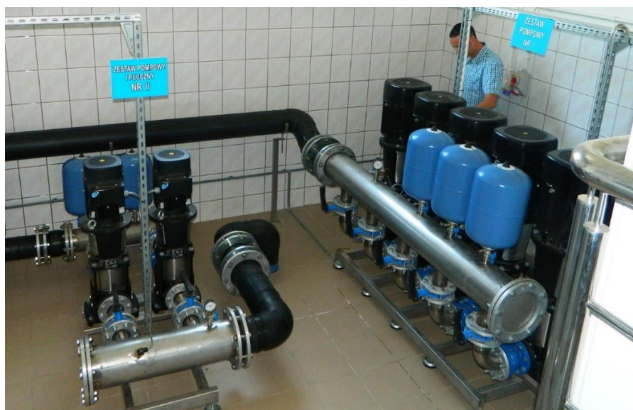
Fot. 2. Elementy Stacji uzdatnia wody w Jasionce: zbiorniki oraz zestaw pompowy.
