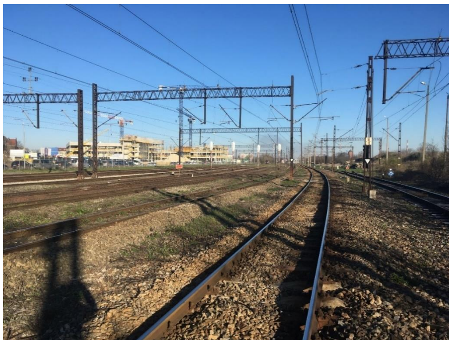
Rys. 5-6 Typowe torowisko na podsypce, z >2 stykami na 100m, w standardowo utrzymane, bez dodatkowych elementów ograniczających emisję hałasu, na łuku o krzywiźnie 1000 – 500 m. Linia kolejowa nr 277, na terenie m. Opola, km 5,170 - 5,300
