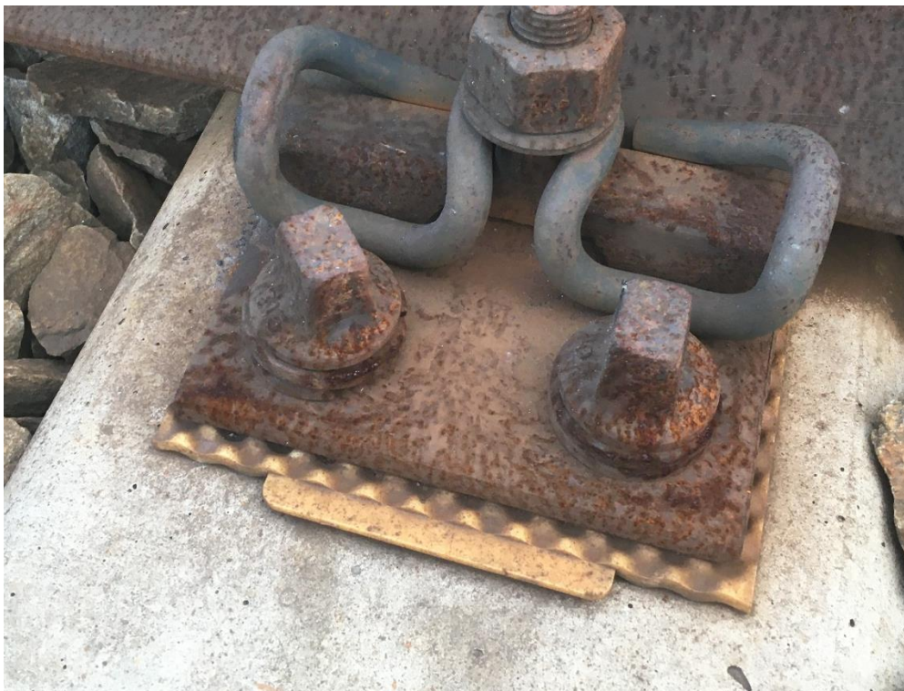
Rys. 5-12 Przekładka podszynowa miękka (150 – 250 NM/m). Zdjęcie wykonane na linii kolejowej nr 132 w m. Tarnów Opolski, woj. opolskie (km. 85+600)
