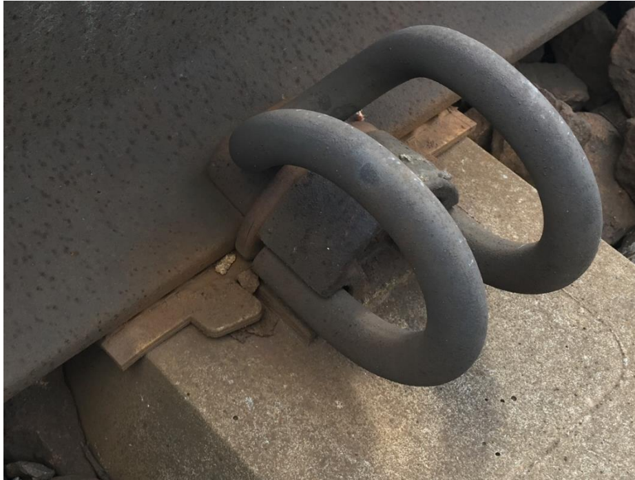
Rys. 5-10 Przekładka podszynowa miękka (150 – 250 NM/m) z przytwierdzeniem sprężystym typu SB3. Zdjęcie wykonane na linii kolejowej nr 144 w m. Fosowskie, woj. opolskie (km. 175+300)
