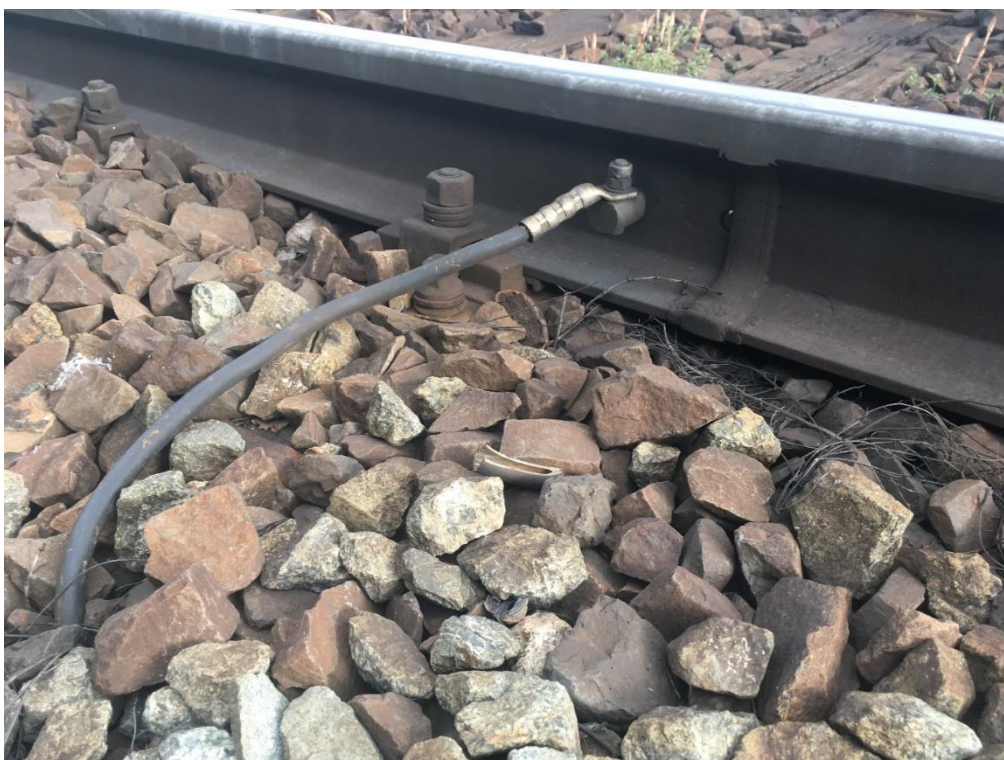
Rys. 5-8 Typowe torowisko na podsypce, z podkładami drewnianymi, z złączami spawanymi/zgrzewanymi, standardowo utrzymane, bez dodatkowych elementów ograniczających emisję hałasu. Linia kolejowa nr 132, tor 1, na terenie m. Opola
