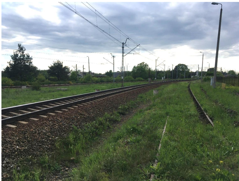
Rys. 5-9 Typowe torowisko na podsypce tłuczniowej, bezstykowe, dobrze utrzymane, bez dodatkowych elementów ograniczających emisję hałasu, na łuku o krzywiznie 500 – 300 m. Linia kolejowa nr 144, na terenie m. Kolonowskie/Fosowskie, w km 175+300
