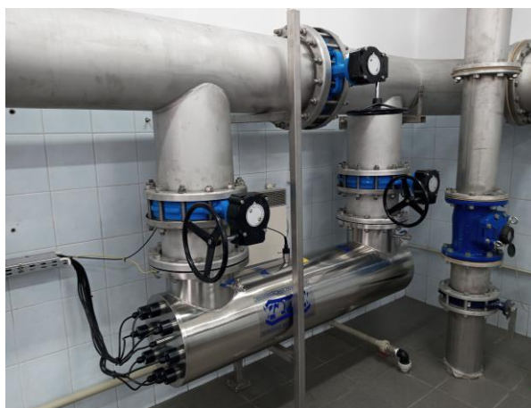
Stacja Uzdatniania Wody w Sulechowie Fot. PSSE Zielona Góra
