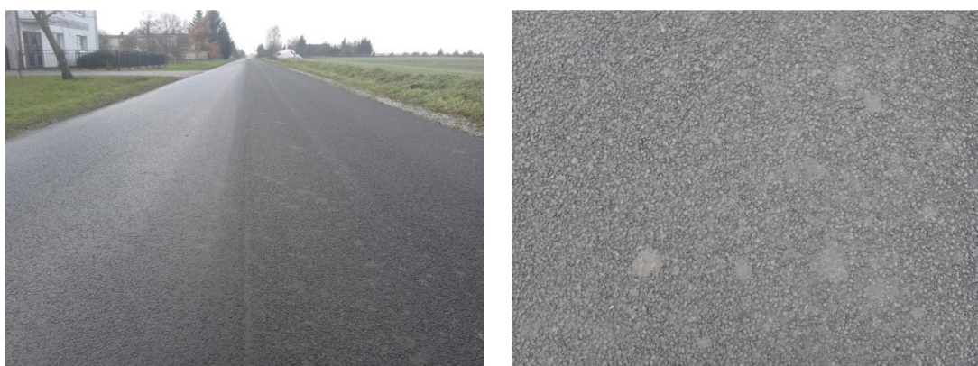
Rys. 5.7 Stan nawierzchni w rejonie punktu pomiarowego
