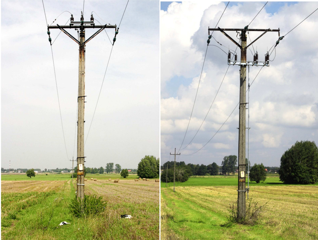
Fot. 12 i 13. Słup linii SN z rozłącznikiem na szczycie i bocianami, które uległy śmiertelnemu porażeniu (po lewej) oraz (po prawej) ten sam słup po modernizacji i zainstalowaniu rozłącznika pod poprzecznikiem, w sposób bezpieczny dla ptaków. Fot. I. K.
