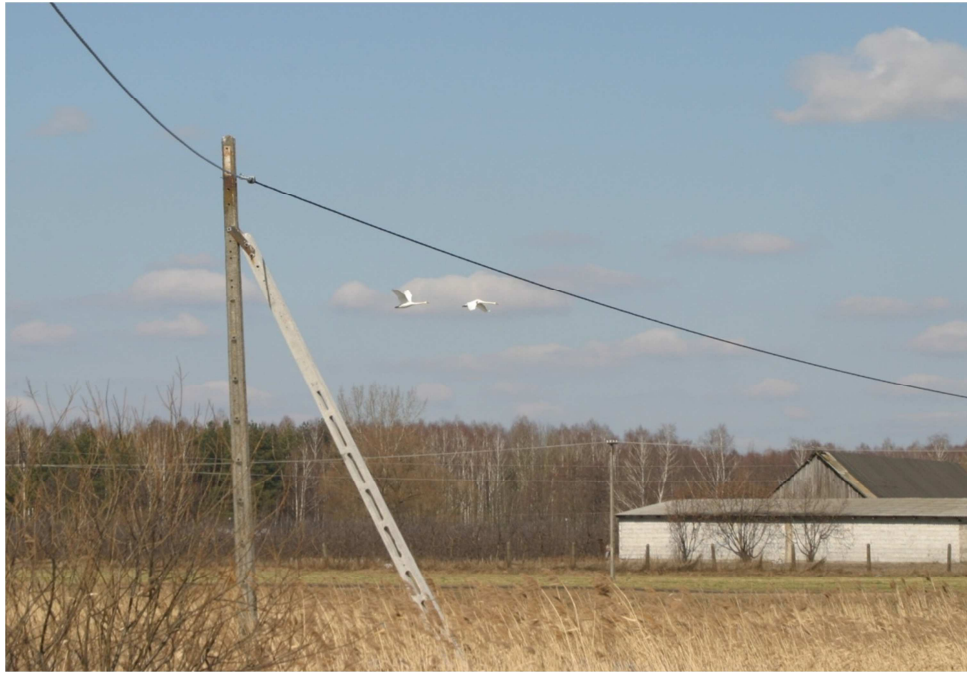
Fot. 17. Połączenie zaizolowanych przewodów uniemożliwia wystąpienie porażenia prądem oraz zwiększa ich widoczność, redukując prawdopodobieństwo kolizji ptaków (tutaj przykład linii niskiego napięcia, gm. Mordy, woj. mazowieckie); fot. I. K.
