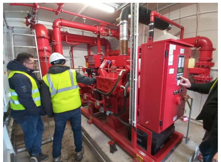
Rysunek 45 Ocena zgodności wykonania z projektem instalacji tryskaczowej w sortowni odpadów w Julkowie
