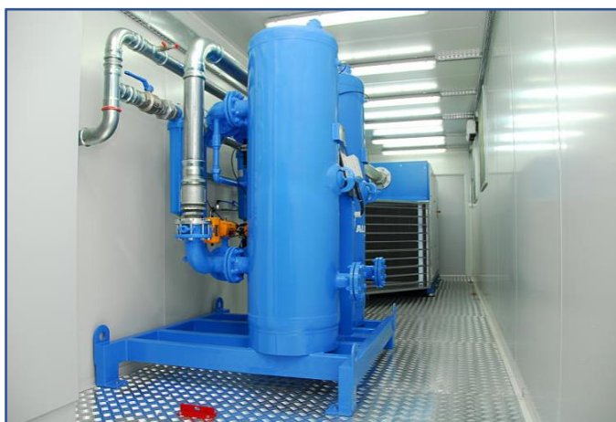
fot. 1 almig: instalacja sprężonego powietrza
