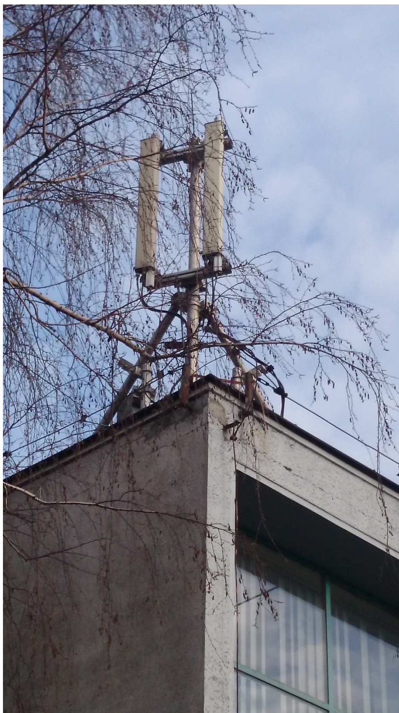
Fot. 2: Widok anten stacji bazowej ID stacji: KRA0222_D zlokalizowanej na dachu budynku użyteczności publicznej w Krakowie przy ul. Kąpielowej 75
