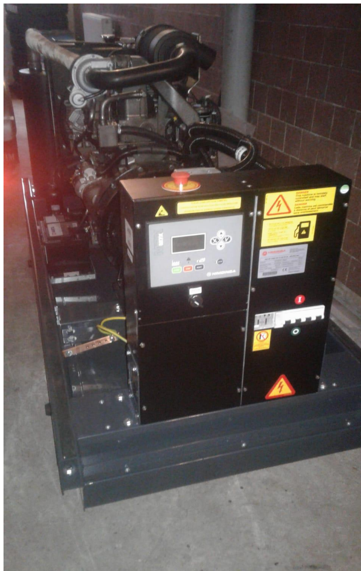
Agregat prądotwórczy JRG Nr 2 w Miastku
