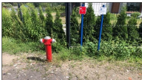
Fot. 23. Sieci wodociągowe przeciwpożarowe z hydrantami zewnętrznymi przeciwpożarowymi.
