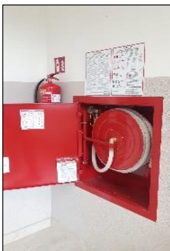
Fot. 12. Instalacje, urządzenia przeciwpożarowe
