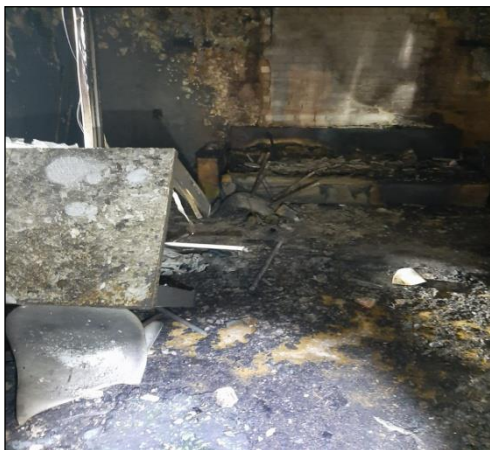
Fot. 46. Pożar domu
