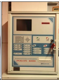
Fot. 18. Instalacje, urządzenia przeciwpożarowe
