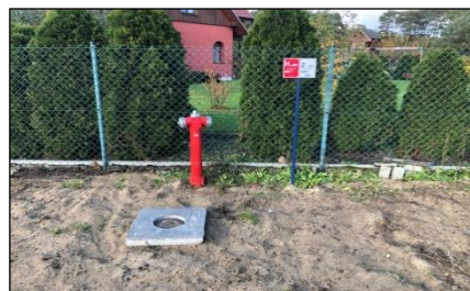
Fot. 24. Sieci wodociągowe przeciwpożarowe z hydrantami zewnętrznymi przeciwpożarowymi.
