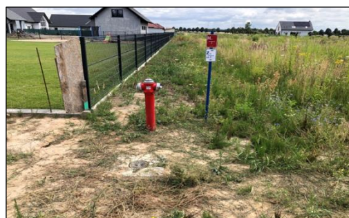
Fot. 22. Sieci wodociągowe przeciwpożarowe z hydrantami zewnętrznymi przeciwpożarowymi.
