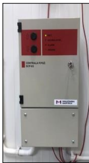
Fot. 17. Instalacje, urządzenia przeciwpożarowe
