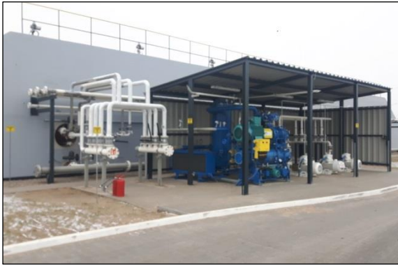
Fot. 6. Obiekty produkcyjno – magazynowe i instalacje technologiczne
