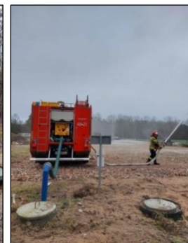
Fot. 15. Instalacje, urządzenia przeciwpożarowe
