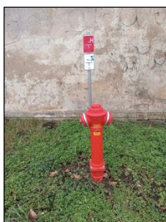
Fot. 21. Sieci wodociągowe przeciwpożarowe z hydrantami zewnętrznymi przeciwpożarowymi.
