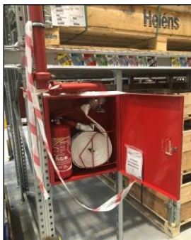
Fot. 16. Instalacje, urządzenia przeciwpożarowe
