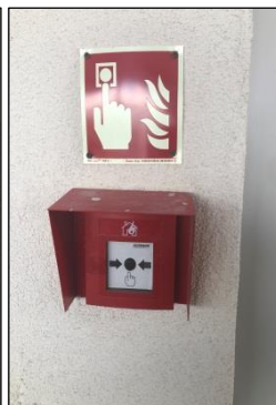
Fot. 13. Instalacje, urządzenia przeciwpożarowe
