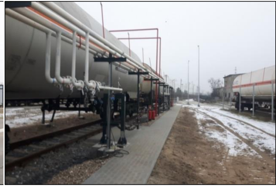
Fot. 7. Obiekty produkcyjno – magazynowe i instalacje technologiczne
