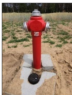
Fot. 20. Sieci wodociągowe przeciwpożarowe z hydrantami zewnętrznymi przeciwpożarowymi.
