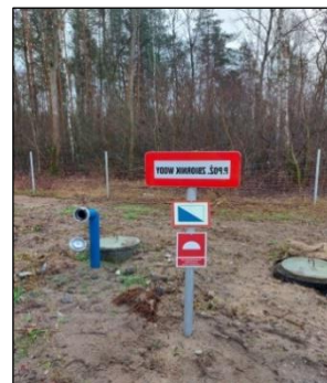
Fot. 14. Instalacje, urządzenia przeciwpożarowe
