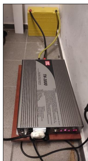
Fot.111. Urządzenie do awaryjnego zasilania serwerowni w KP PSP w Czarnkowie
