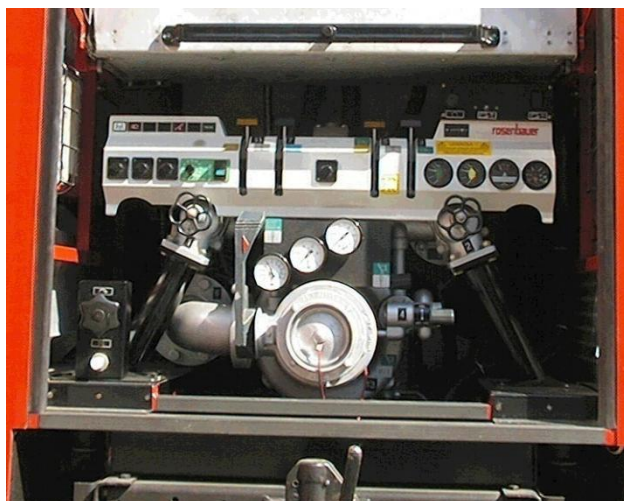
Fotografia nr 4.7. Widok stanowiska obsługi autopompy NH 20
