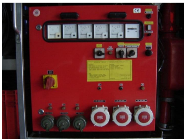
Fotografia nr 6.7. Panel obsługowo kontrolny agregatu zamontowanego na stałe w samochodzie pożarniczym
