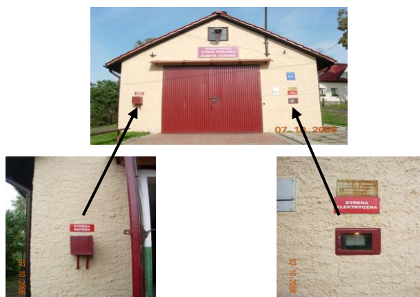
Fotografia nr 10.1. Widok i oznakowanie syreny ręcznej i włącznika syreny elektrycznej
