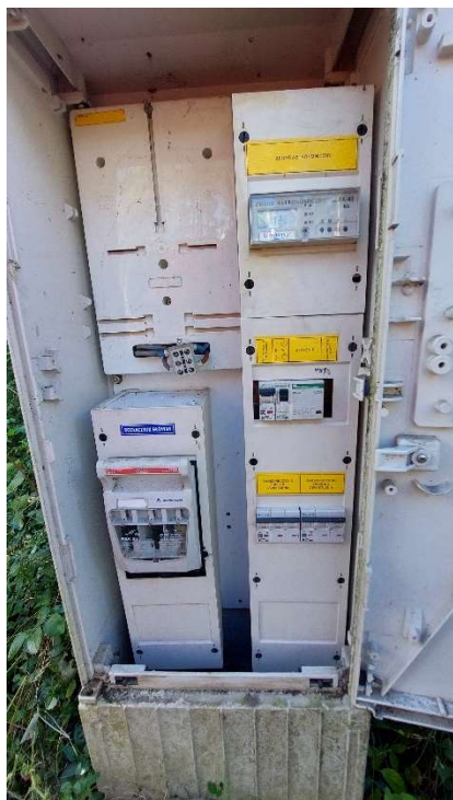
Szafka oświetleniowa Buszkowo
