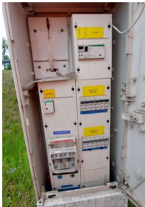
Szafka oświetleniowa Nieżywiec
