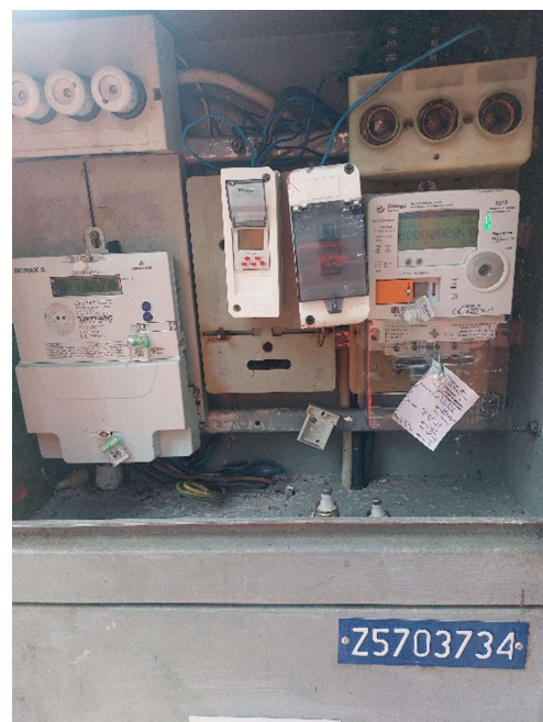
Oświetlenie parking Gwieździn (szafka oświetleniowa)
