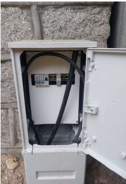
Oświetlenie parking Gwieździn (szafka oświetleniowa – do przepięcia zasilania)
