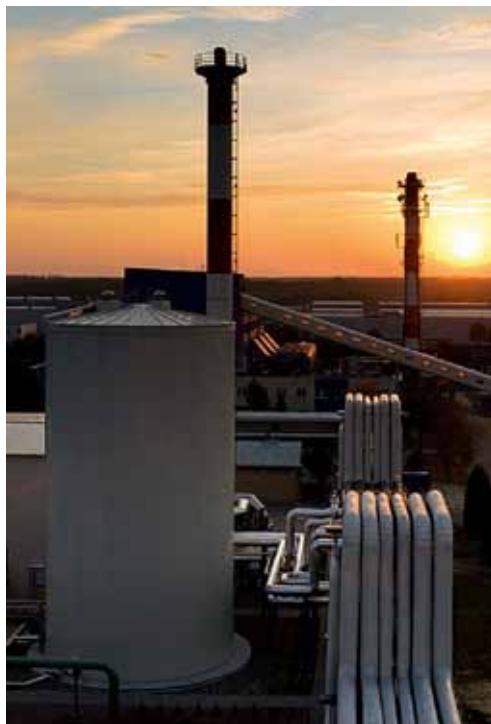
Akumulator ciepła i komin instalacji gazowej. Fot. G. Bylicki
