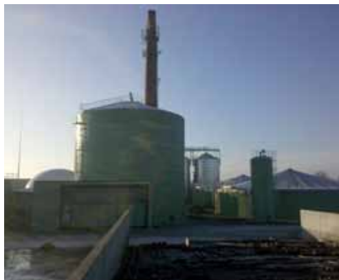
Zbiornik fermentacyjny. Fot. S. Łazarski
