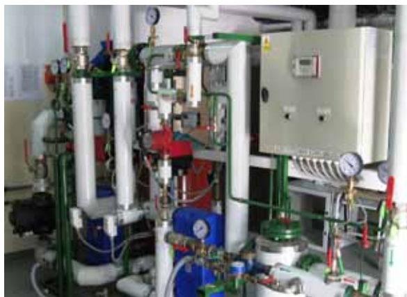
Węzeł ciepły szpitala miejskiego w Gdyni. Fot. S. Wasilewski
