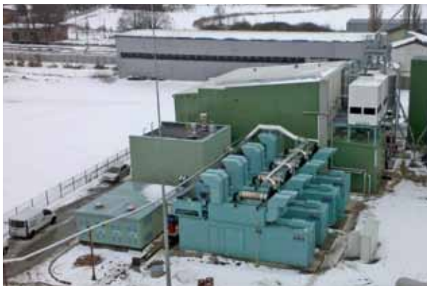
Agregaty kogeneracyjne. Fot. S. Łazarski
