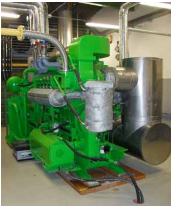
Biogazownia rolnicza w Świelinie – moduł CHP Fot. Poldanor S.A.
