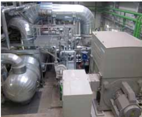
Maszynownia - turbogenerator i wymiennik ciepłowniczy. Fot. M. Kansy
