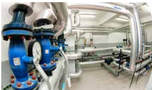
Wnętrze węzła ciepłego. Fot. R. Dadas
