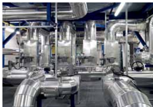
Układ wyprowadzenia mocy ciepłej. Fot. G. Bylicki
