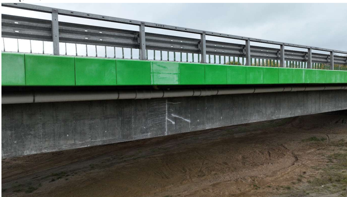
Fot.6 typowe zarysowanie na styku faz budowy
