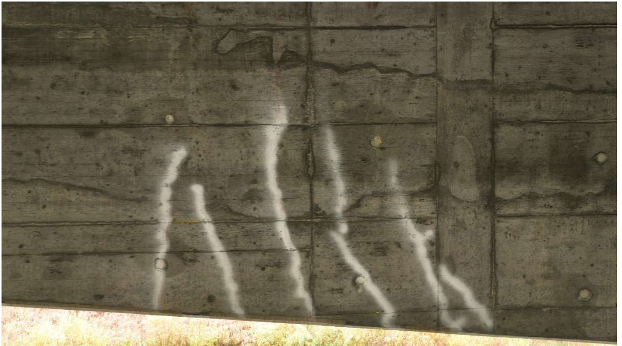
Fot 9. Zarysowanie belki przęsła nr 3 – jezdnia południowa, dźwigar południowy
