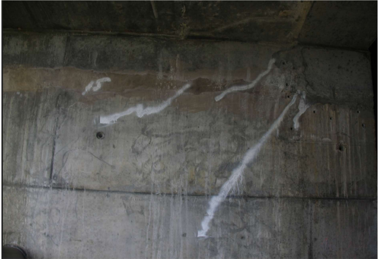
Fot 4 Układ zarysowań łożnicy dźwigara skrzynkowego na przyczółku po stronie Szczecina przy wnęcie dylatacyjnej
