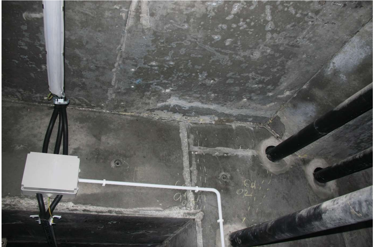
Fot.2 Reprezentatywny układ zarysowań poprzecznicy estakady E1. Oznaczenia zarysowań pochodzą najprawdopodobniej z okresu budowy.
