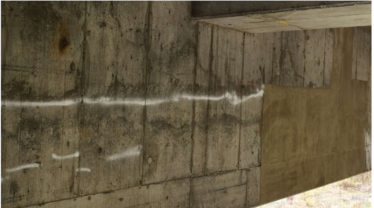
Fot 7 Zarysowanie poziome po wewnętrznej stronie belki
