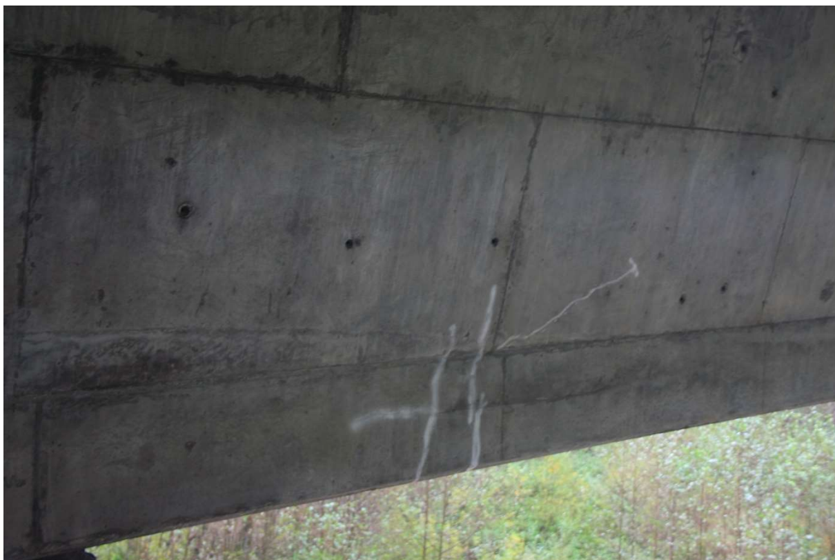
Fot.3 Układ zarysowań estakady E1 na przyczółku od strony Szczecina
