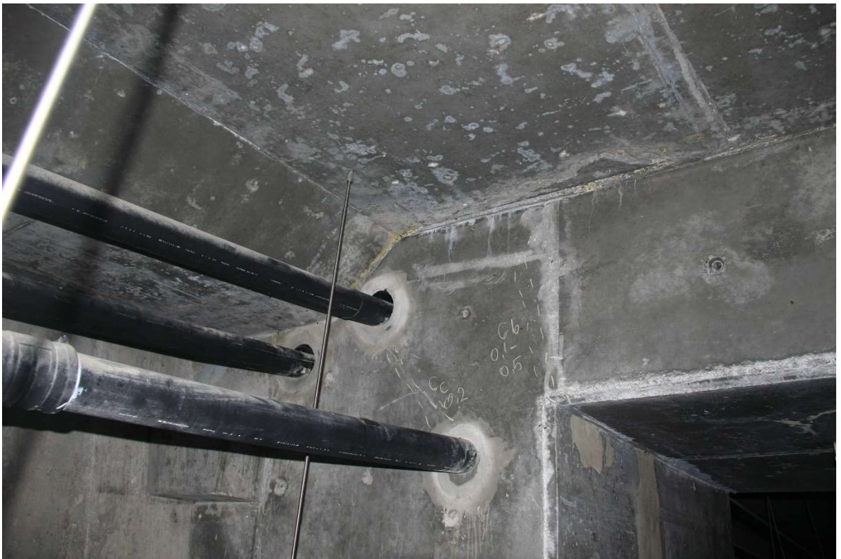
Fot.1 Reprezentatywny układ zarysowań poprzecznic estakady E1. Oznaczenia zarysowań pochodzą najprawdopodobniej z okresu budowy.
