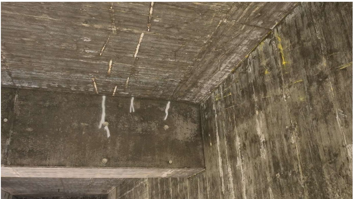
Fot 8. Zarysowania pionowe poprzecznic
