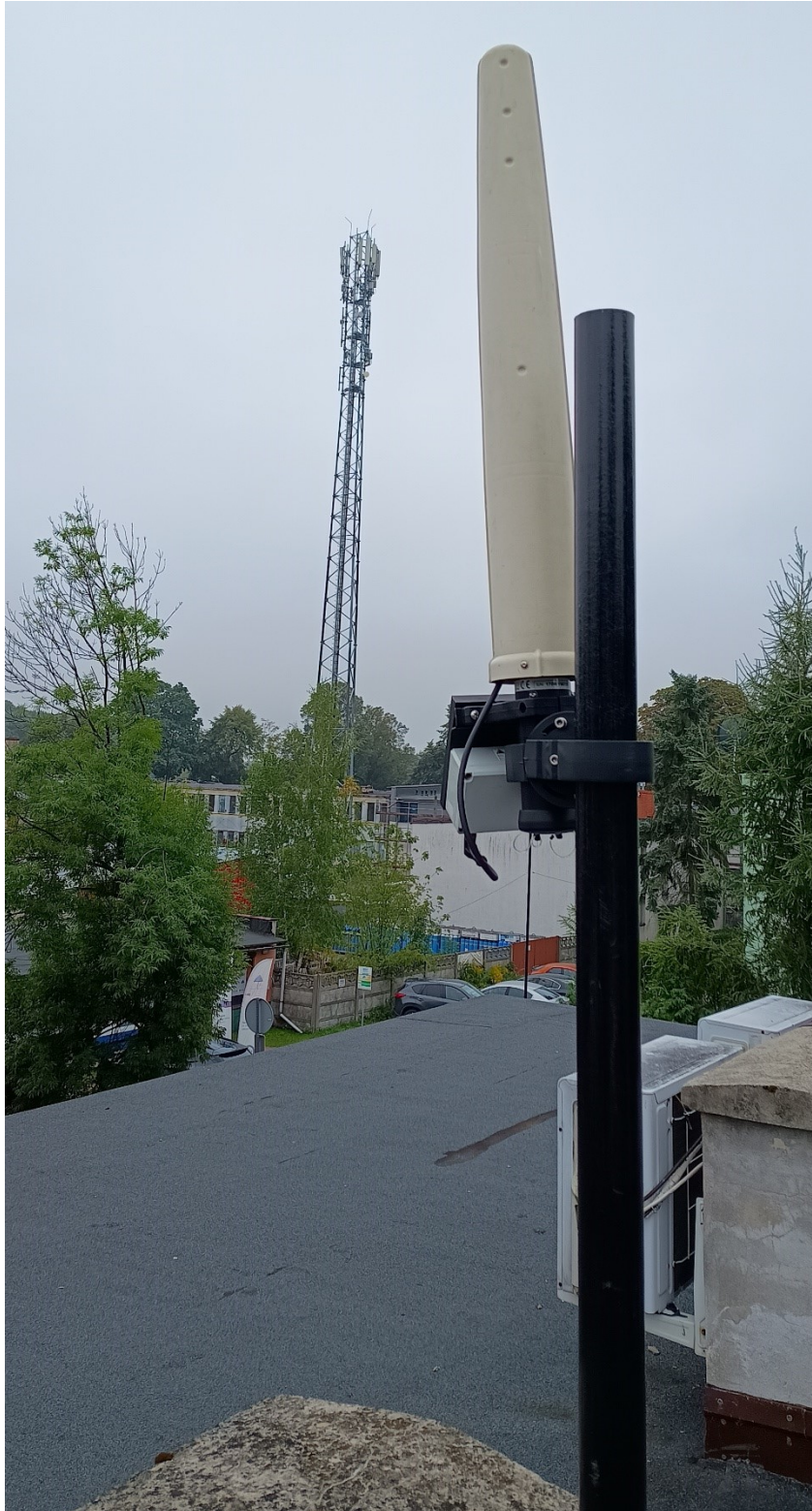
Rys. 2 Miejsce montażu SMS PEM – Tarnogórski Ośrodek Terapii Uzależnień – widok na SBTk
