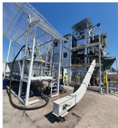
■ Instalacja ZEWERO (zgazywanie osadów ściekowych)
