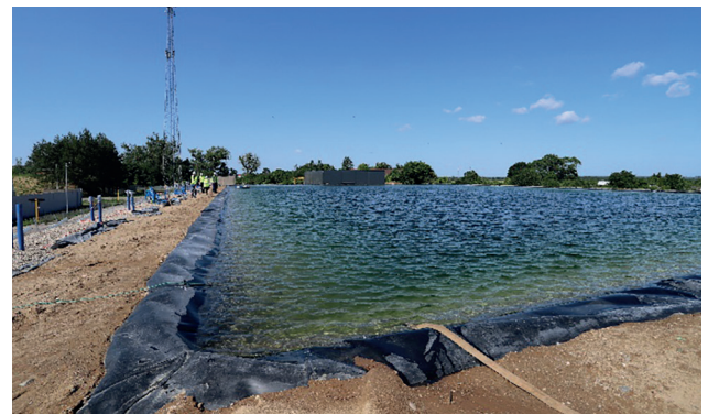
■ Magazyn sezonowy ciepła, wypełniony wodą, przed zamknięciem pokrywy górnej
