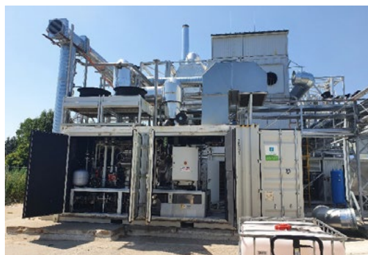
■ Instalacja ZEWERO (zgazywanie osadów ściekowych), gazogenerator do produkcji energii elektrycznej
