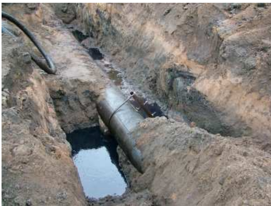
Fot. 1. Rurociąg z widoczną warstwą zanieczyszczenia zbierającego się na powierzchni wód gruntowych
