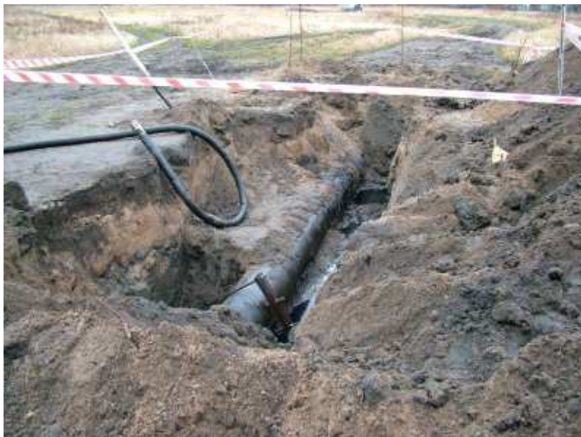
Fot. 2. Rurociąg z widocznym węzłem do odpompowywania zanieczyszczeń
