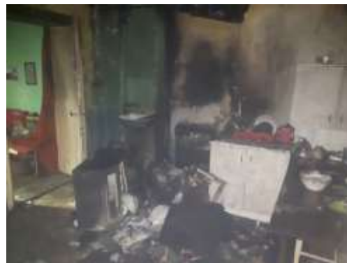
Fot. 29. Pożar budynku wielorodzinnego
