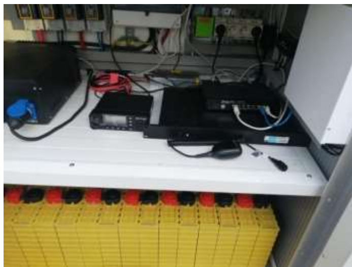
Fot. 80. Podzespoły łączności bezprzewodowej
