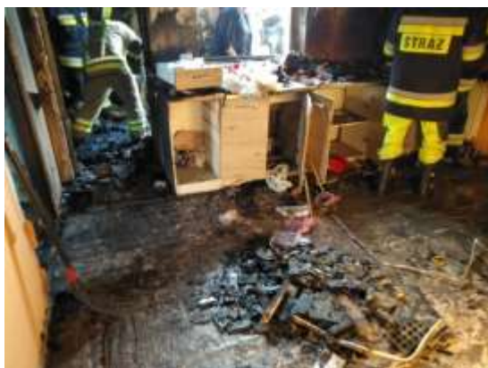
Fot. 18. Pożar budynku mieszkalnego
