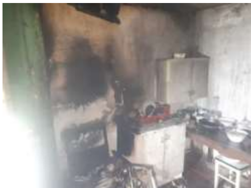
Fot. 28. Pożar budynku wielorodzinnego
