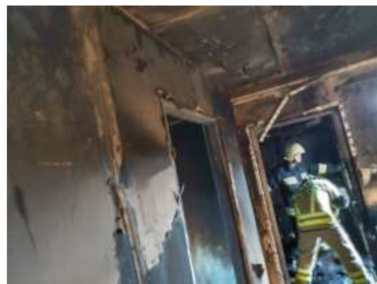
Fot. 19. Pożar budynku mieszkalnego
