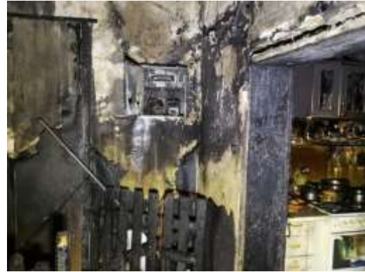
Fot. 31. Pożar budynku mieszkalnego
