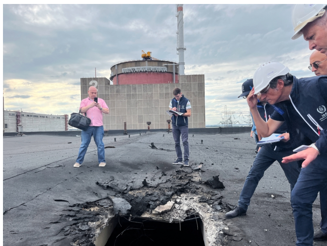
Fot. 3. Misja Międzynarodowej Agencji Energii Atomowej dokonuje inspekcji zniszczeń dokonanych przez Rosjan podczas inwazji na Ukrainę w Zaporoskiej Elektrowni Jądrowej (źródło: IAEA Imagebank Photo Credit: Fredrik Dahl / IAEA, https://www.flickr.com/photos/iaea_imagebank/52339383057/ , dostęp 15.03.2023).
