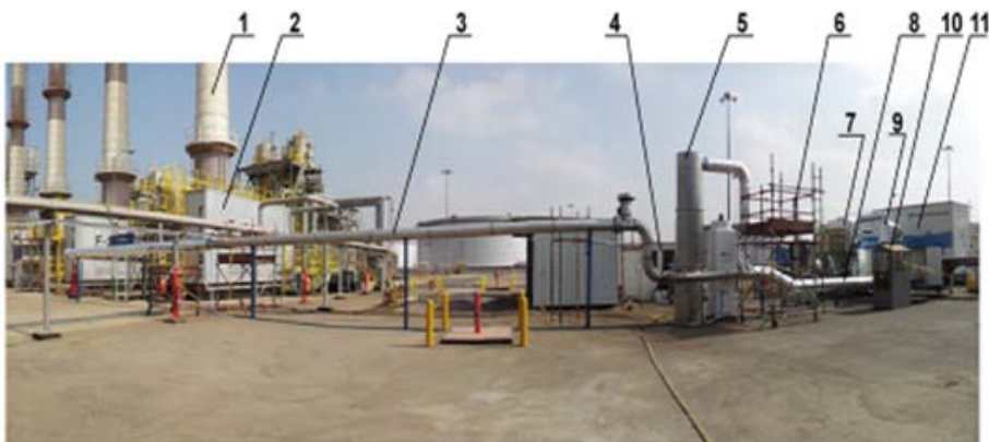
Rys. 4.17. Widok na instalację do oczyszczania gazów w Rafinerii Jedahh w Arabii Saudyjskiej: 1 – komin kotła F 1001, 2 – kocioł F 1001, 3 – rurociąg, 4 – sterownia, 5 – nawilżanie, 6 – komin instalacji pilotowej, 7 – filtr workowy, 8 – izolowany fragment rurociągu, 9 – cyklon, 10 – przechowywanie i podawanie amoniaku, 11 – mobilny akcelerator elektronów
