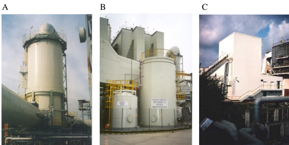
Rys. 9.16. Podstawowe urządzenia Instalacja Oczyszczania Spalin Elektrowni Pomorzany: A – wieża nawilżania spalin; B – zbiornik wody amoniakalnej; C – Instalacja gromadzenia produktu ubocznego
