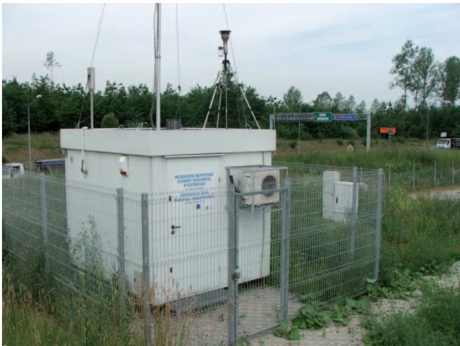
Fot. 3. Stacja pomiarowa monitoringu emisji w Chorzowie (źródło: WIOŚ)
