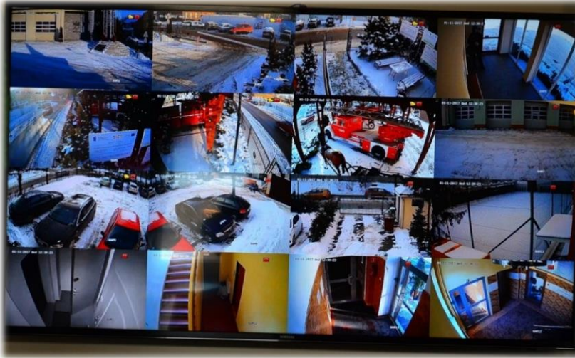
Fot. 36 Monitor systemu zainstalowany na SKKW PSP w Gdańsku.
