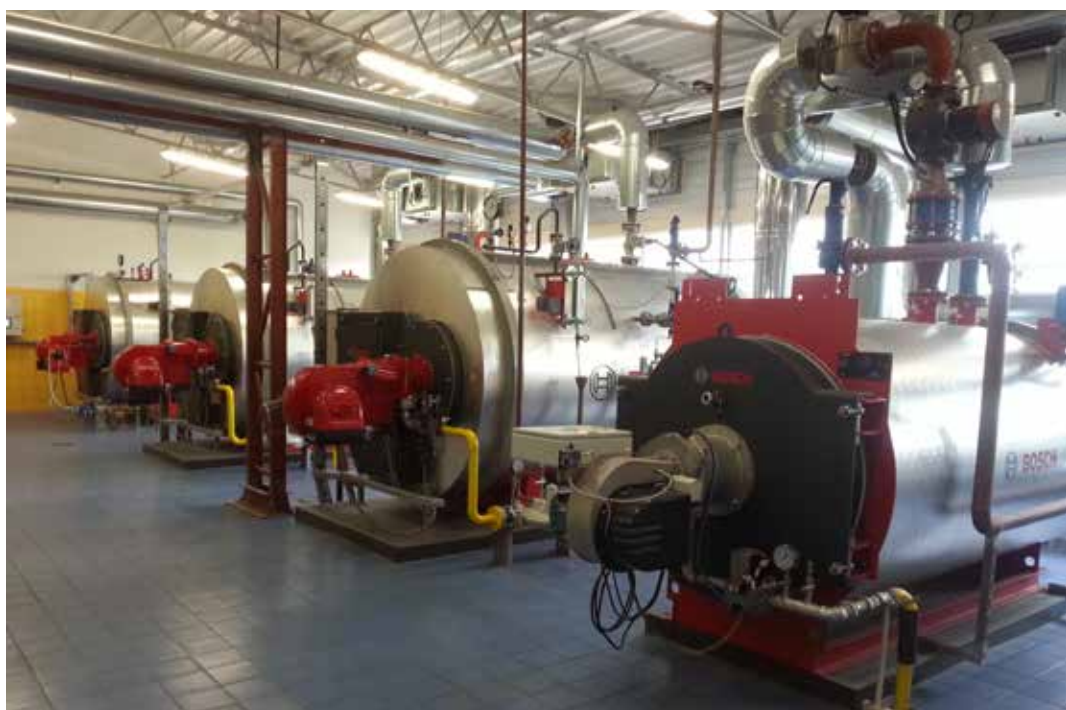
Zmodernizowany system energetyczny w Szpitalu Wojewódzkim w Kaliszu. Fot. Wojciech Grzelak
