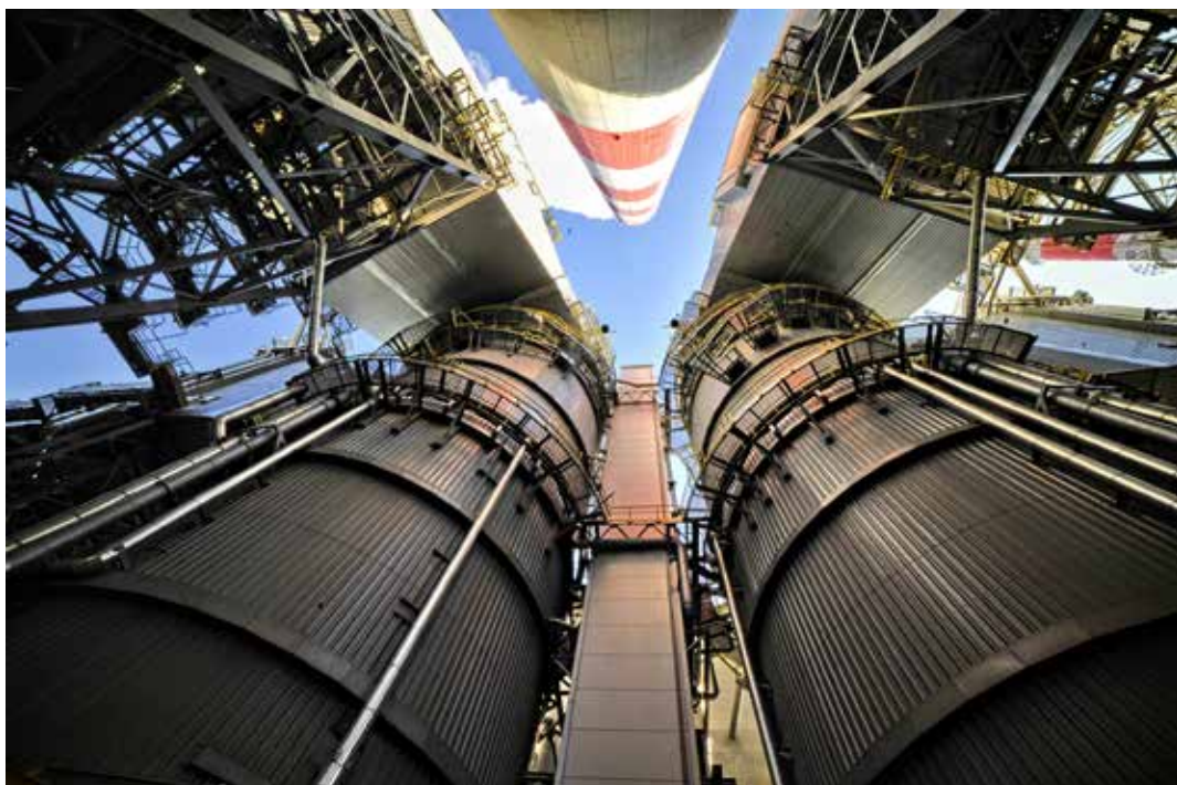
Instalacja mokrego odsiarczania i katalitycznego odazotowania spalin w EC Siekierki. Fot. Tomasz Banasik
