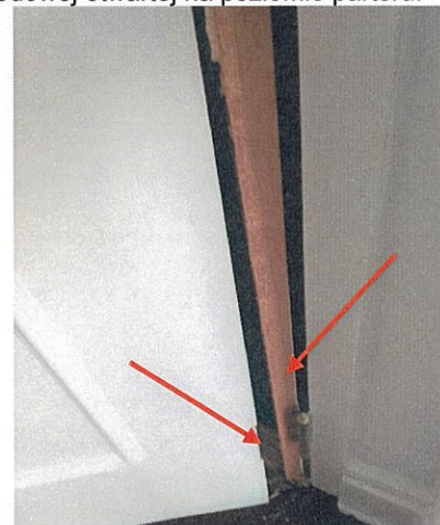
Fot. 54. Widok na uszkodzone drzwi wejścia na piętro z klatki schodowej otwartej na poziomie parteru.
