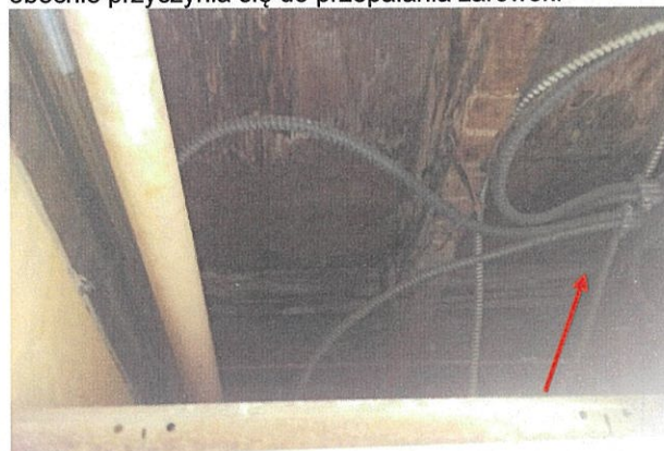
Fot. 39. Widok na konstrukcję stropu i ślady przebarwień po dawnych zawilgoceniach w pom. socjalnym na parterze. Widok na instalację, która uległa zalaniom i obecnie przyczynia się do przepalania żarówek.
