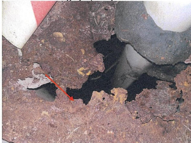
Fot. 14. Widok na zniszczony na skutek korozji dekiel studzienki kanalizacyjnej w piwnicy.
