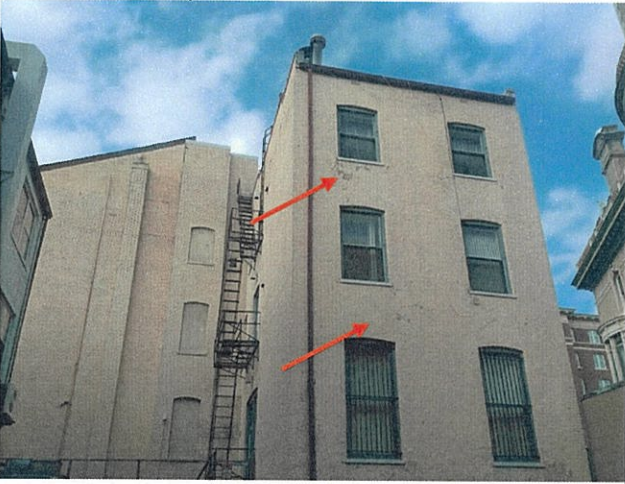
Fot. 77. Widok na elewację tylną budynku -odpryski powłoki malarskiej.
