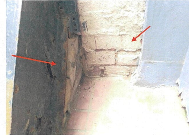
Fot. 20. Widok na uszkodzenia ścian i korozję schodów stalowych przy wejściu z zewnątrz do pomieszczeń piwnic (biblioteki).
