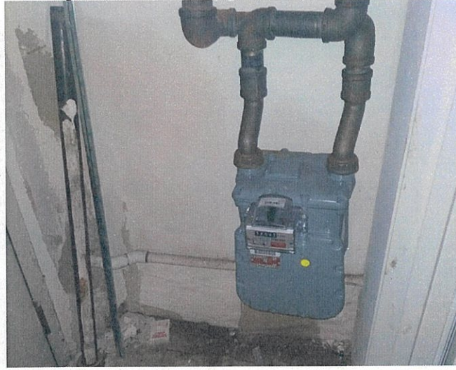
Fot. 26. Widok na uszkodzenia na ściekanie w pom. licznika gazu - stan instalacji gazu dobry,
