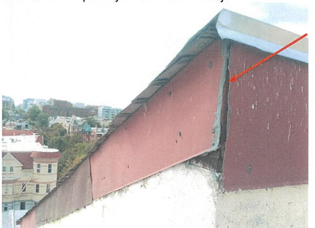
Fot. 72. Widok na brak odpowiedniego wykończenia obróbek dachu przekrycia klatki schodowej.
