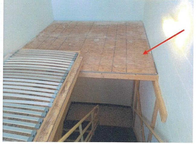
Fot. 44. Widok na wykonaną zabudowę na klatce schodowej ewakuacyjnej z płyt OSB na listwach drewnianych tj. z materiałów palnych.
