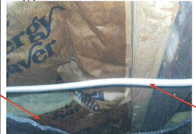
Fot. 67. Widok na przestrzeń poddasza nieużytkowego - ocieplenie przy pomocy wełny z zabezpieczeniem folią aluminiową i papierem oraz niezaimpregnowane elementy więźby dachowej stanowiące wzmocnienia istniejących krokiew dachu.
