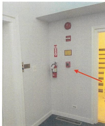
Fot. 58. Widok na oznakowanie ppoż na korytarzach budynku.
