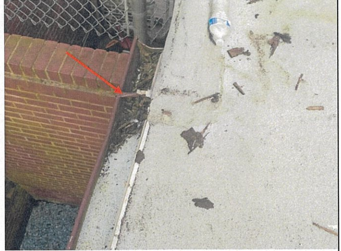
Fot. 82. Widoczne zanieczyszczenia rynien na dachu nad pomieszczeniem konferencyjnym parteru.
