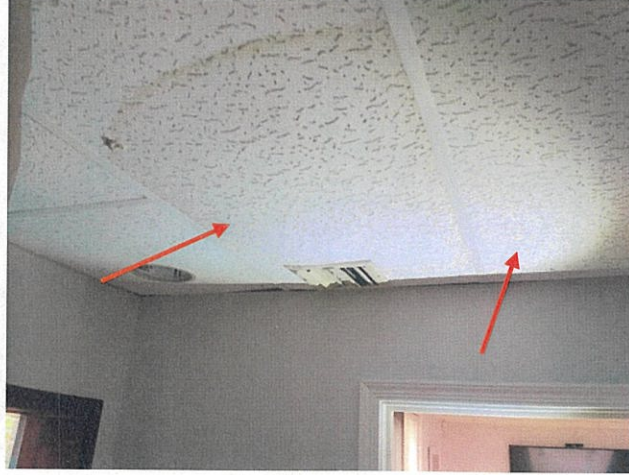
Fot. 36. Widok na uszkodzenia kasetonów zabudowy sufitu podwieszanego w pomieszczeniu socjalnym na parterze.
