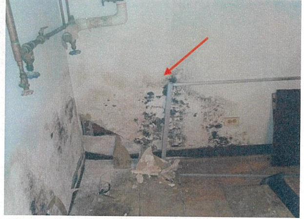
Fot. 2. Ubytki i zniszczenia dawnej izolacji wodoszczelnej powłokowej ścian od wewnątrz budynku, grzyb na ścianach.
