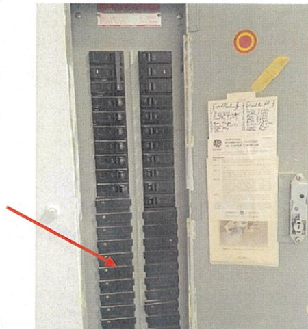
Fot. 59. Widok na tablicę piętrową - instalacja starego typu.
