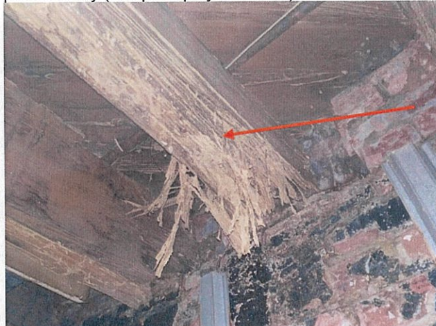
Fot. 28. Widok na belkę stropu nad piwnicą zniszczoną przez termity (nad pom. przy bibliotece).
