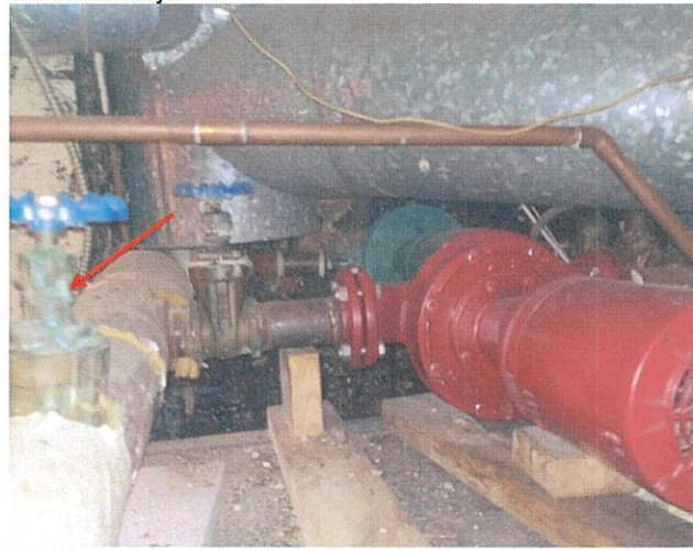
Fot. 23. Widok na instalacje w pom. tech. i miejscowe oznaki korozji.
