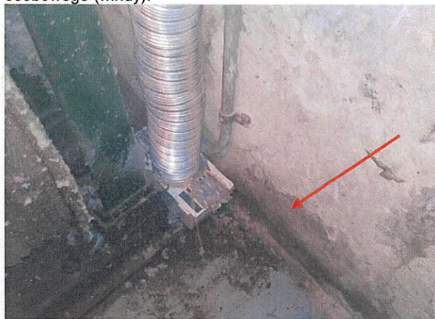
Fot. 16. Widok na zawilgocenia ścian murowanych i uszkodzenia tynków w pomieszczeniu maszynowni dźwigu osobowego (windy).
