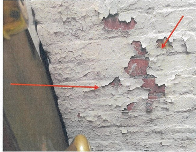
Fot. 21. Widok na uszkodzenia ścian przy wejściu z zewnątrz do pomieszczeń piwnic (biblioteki).
