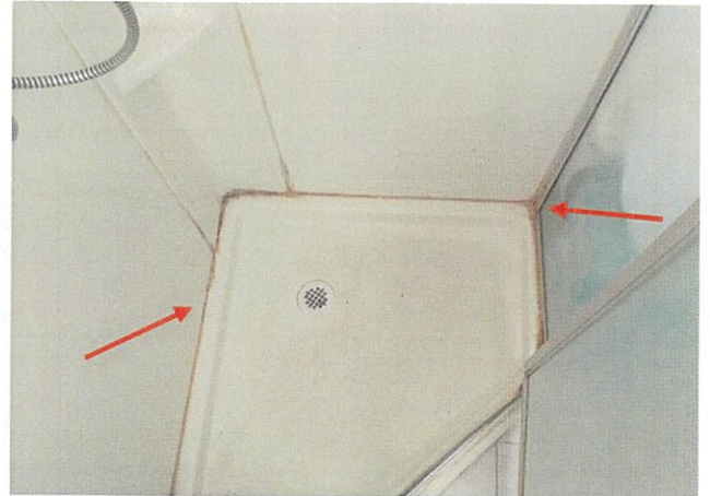
Fot. 48. Widok na brodzik z wykonanymi uszczelnieniem za pomocą silikonu – nie zapewnia stałego i szczelnego uszczelnienia.
