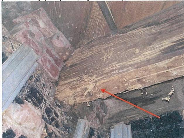
Fot. 30. Widok na belkę stropu nad piwnicą zniszczoną przez termity (nad pom. przy bibliotece).
