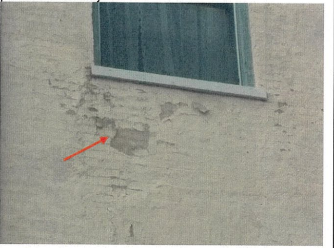
Fot. 78. Widok na elewację tylną budynku -odpryski powłoki malarskiej.
