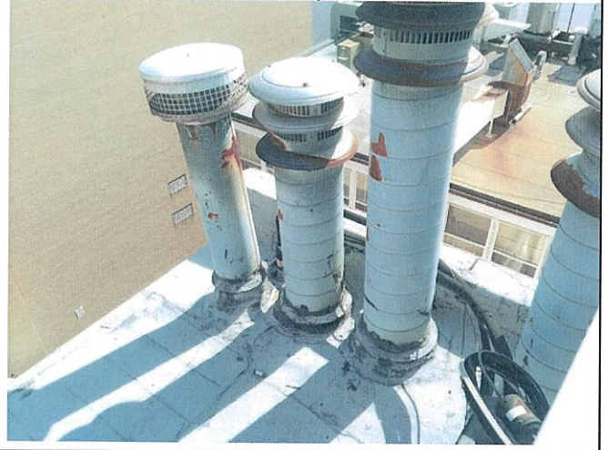
Fot. 88. Widoczna korozja na rurach wywiewek wyprowadzonych nad dach budynku,
