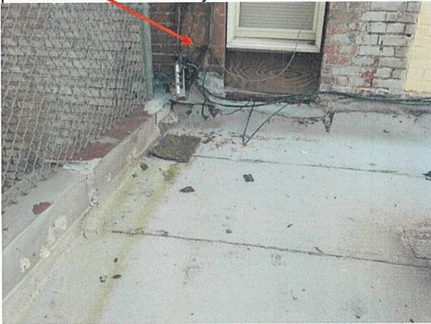
Fot. 83. Widok na dach i wykonane obróbki oraz poprowadzenie instalacji po budynku oraz zabudowę pod oknem na ścianie budynku.
