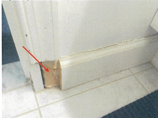
Fot. 50. Widok na listwę drewnianą przypodłogową z częściowym brakiem w pomieszczeniu łazienki.
