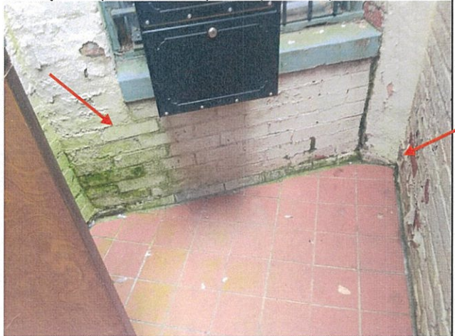
Fot. 19. Widok na uszkodzenia ścian przy wejściu z zewnątrz do pomieszczeń piwnic (biblioteki).
