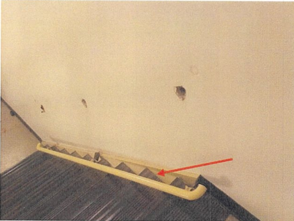
Fot. 45. Widok na balustradę która leży na biegu schodów – wyrwana ze ściany ze względu na zbyt słabe umocowanie/zakotwienie.
