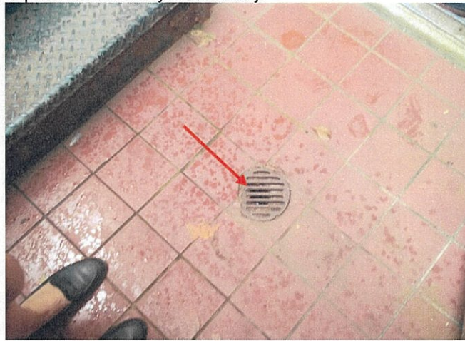
Fot. 18. Widok na odwodnienie przy wejściu z zewnątrz do pomieszczeń piwnic (biblioteki). Wypust zbyt mały dla odprowadzenia wody deszczowej.
