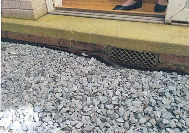
Fot. 87. Widok na brak odpowiedniego zabezpieczenia ściany fundamentowej przy budynku od strony dobudowanego pom. konferencyjnego, kratka wentylacyjna na poziomie gruntu.
