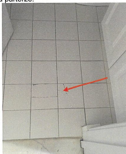
Fot. 40. Widok na popękane płytki w pomieszczeniu łazienki na parterze.
