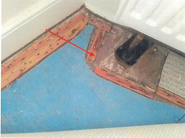
Fot. 47. Widok na strop nad wyższymi kondygnacjami budynku - strop drewniany z podłogą drewnianą.
