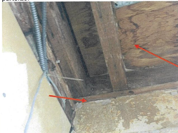
Fot. 37. Widok na konstrukcję stropu i ślady przebarwień po dawnych zawilgoceniach w pom. socjalnym na parterze.
