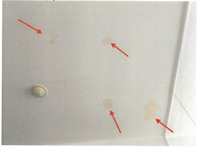
Fot. 46. Widok na ślady po zawilgoceniu na zabudowie stropu nad 3 pięciem.
