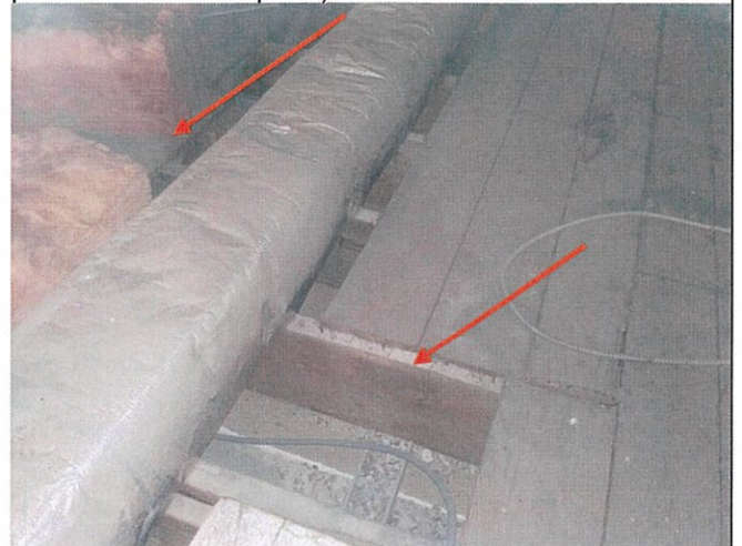
Fot. 68. Widoczne miejscowe braki wykonanego ocielenia w stropie nad ostatnią kondygnacją (tylko na części, pozostała część ocieplona).
