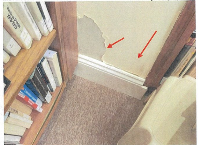
Fot. 12. Widok na ślady wilgoci na ścianach piwnic w bibliotece i uszkodzenia elementów zabudowy z płyt g-k.
