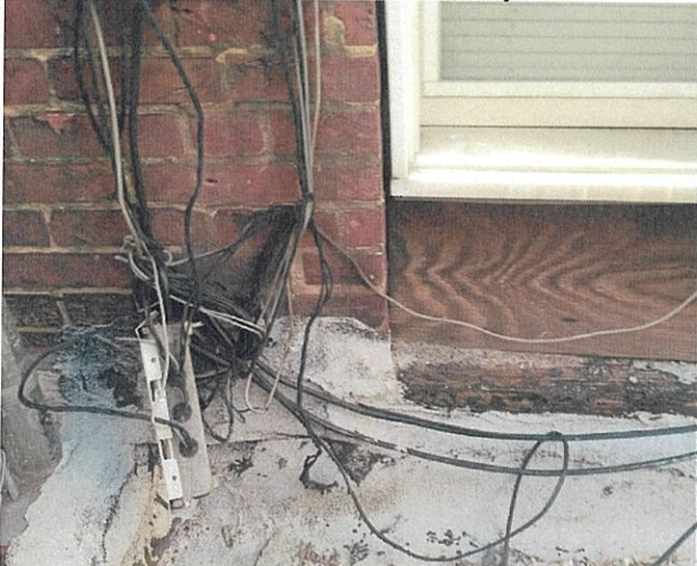
Fot. 85. Widok na poprowadzenie instalacji po budynku oraz zabudowę pod oknem ba ścianie budynku.
