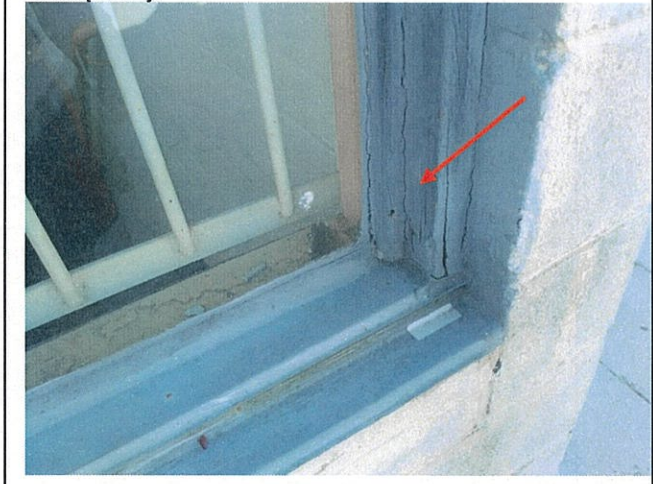
Fot. 65. Widok na zniszczoną stolarkę okienną od strony zewnętrznej.
