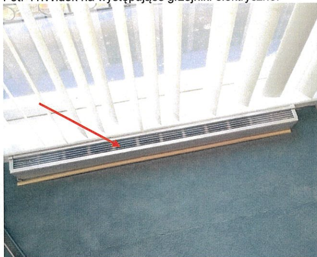
Fot. 41. Widok na występujące grzejniki elektryczne.
