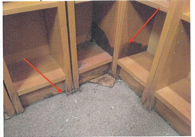
Fot. 10. Widoczne zawilgocenia wykładziny i elementów wyposażenia w pomieszczeniach piwnic o przeznaczeniu na bibliotekę.
