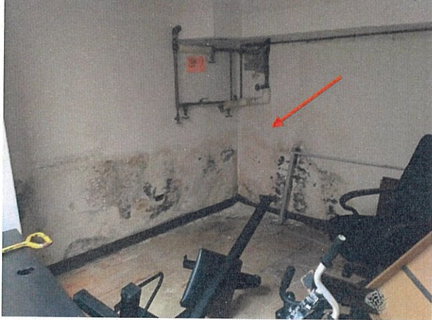
Fot. 1. Widok na zagrzybenie ścian i zabudów g-k w pomieszczeniu piwnic od strony frontowej budynku.
