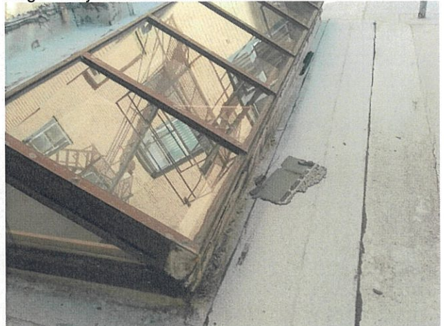
Fot. 84. Widok na świetlik dachowy i obróbki pokrycia wokół niego - miejscowe uszkodzenia.
