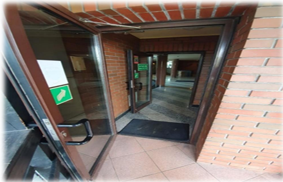
Fotografia 1 Drzwi wyjściowe z klatki schodowej prowadzące na zewnątrz budynku zawężone poniżej wymaganej szerokości.
