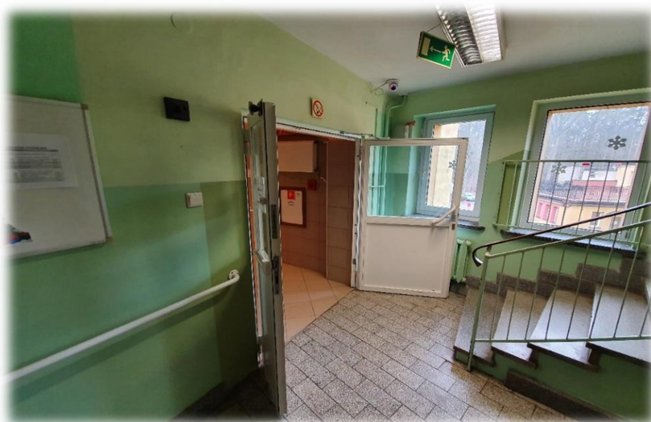
Fotografia 2 Niesprawne elektroztrzymacze oraz na stałe otwarte drzwi ppoż. zainstalowane w ścianie oddzielenia ppoż. w budynku ZL II.
