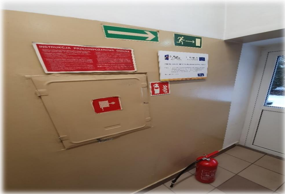
Fotografia 4 Hydrant zamknięty za pomocą opasek kablowych.
