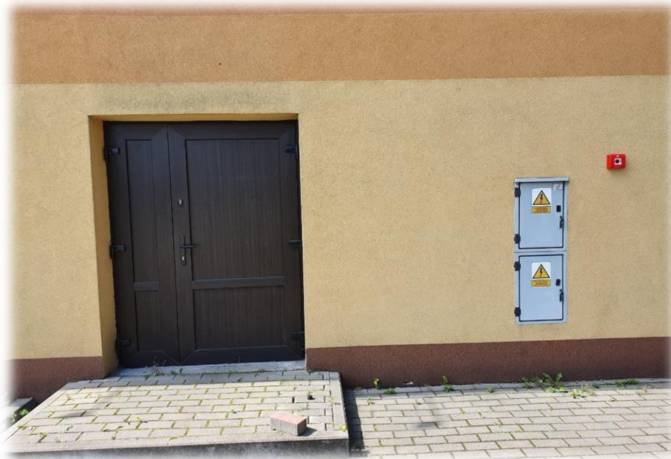
Fotografia 5 Brak oznakowania przeciwpożarowego wyłącznika prądu w budynku ZL III.
