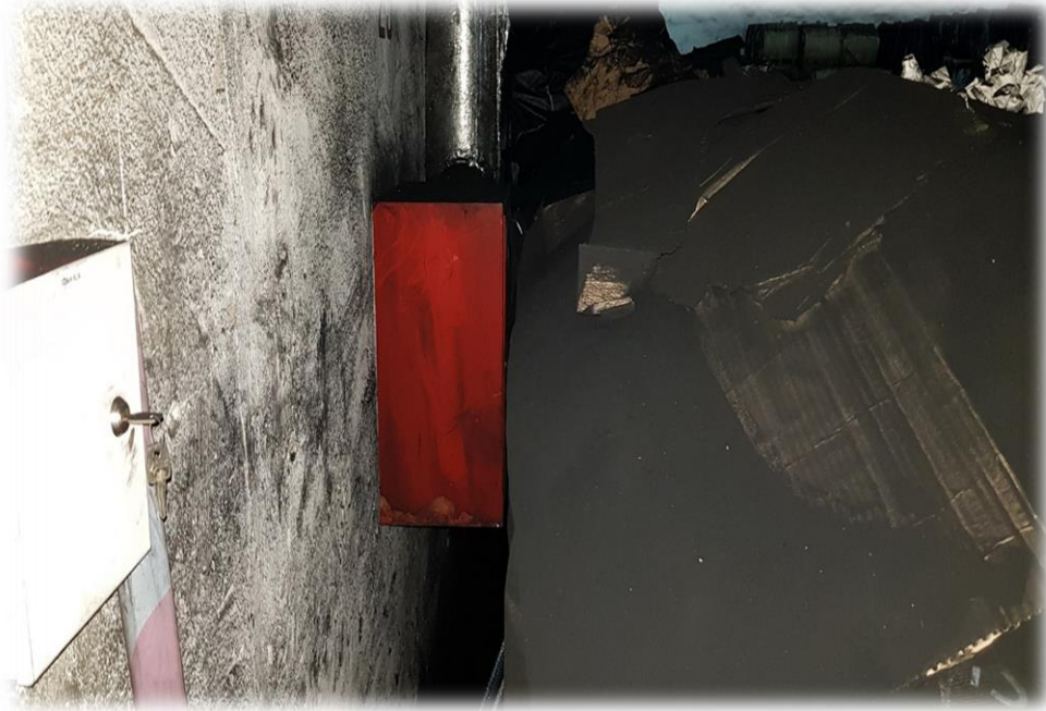
Fotografia 9 Zastawiona szafka hydrantowa w hali magazynowej
