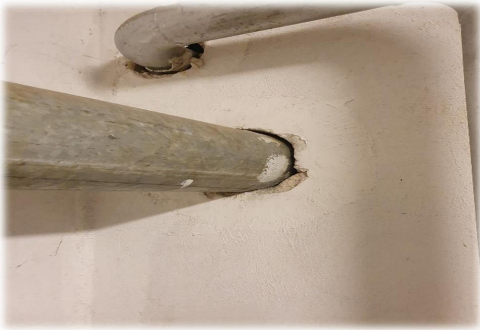
Fotografia 3 Brak zabezpieczenia przepustów w ścianie oddzielenia przeciwpożarowego.
