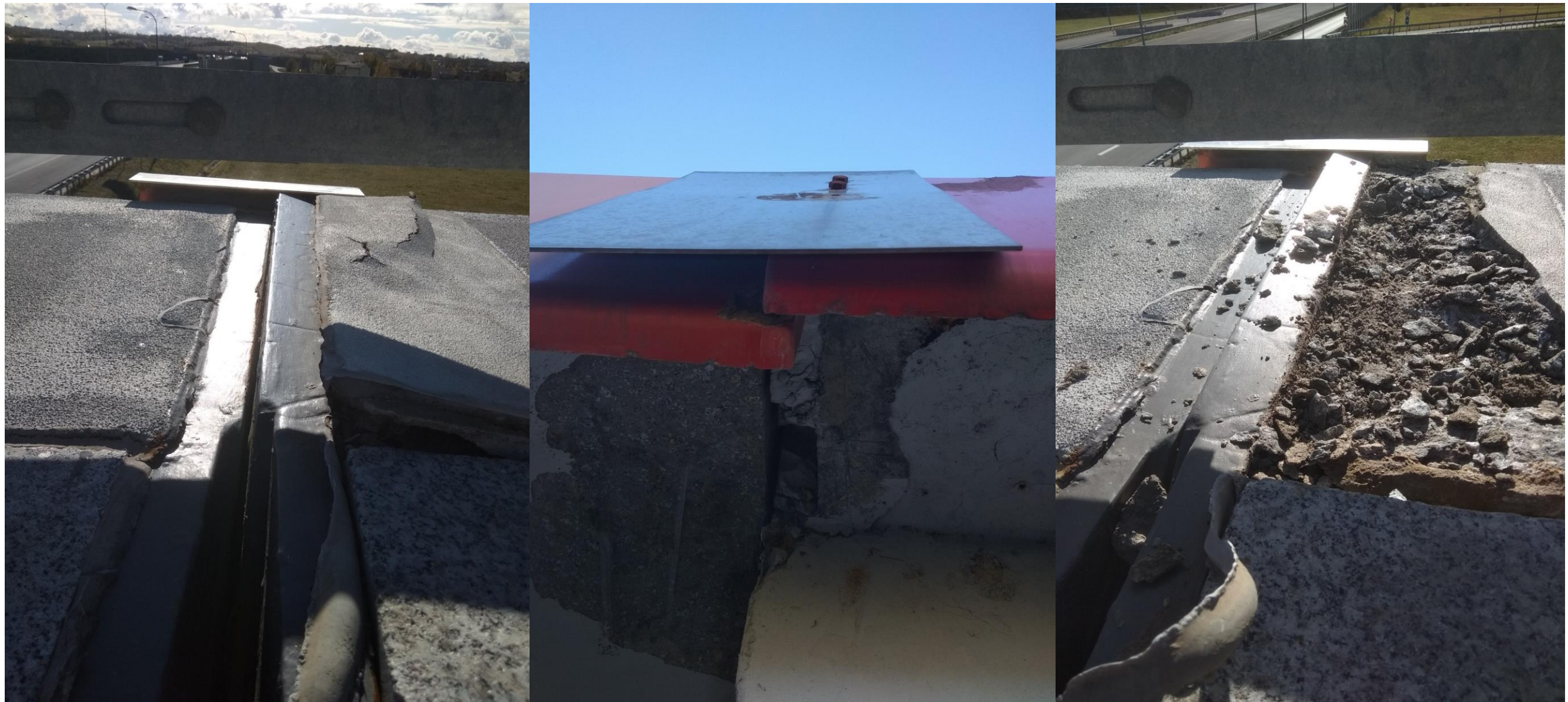
Uszkodzenia obiektu WD-416 na węźle Pyrzowice Zaciśnięte dylatacje
