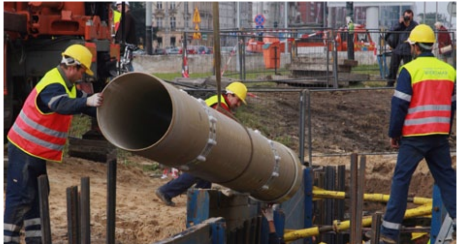
Roboty wodno-kanalizacyjne na Al. Józefa Piłsudskiego w Łodzi (fot. Łódzka Spółka Infrastrukturalna Sp. z o.o.)
