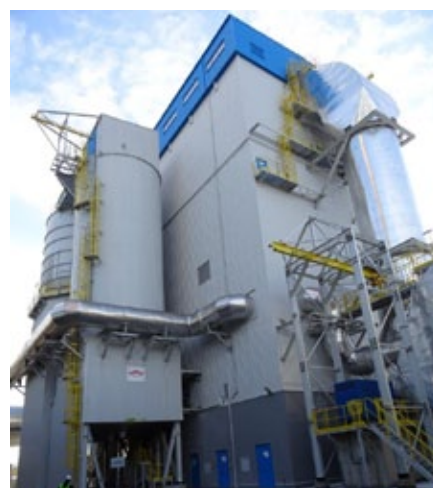
Obiekty elektrociepłowni (fot. Enea Ciepło w Białymstoku)
