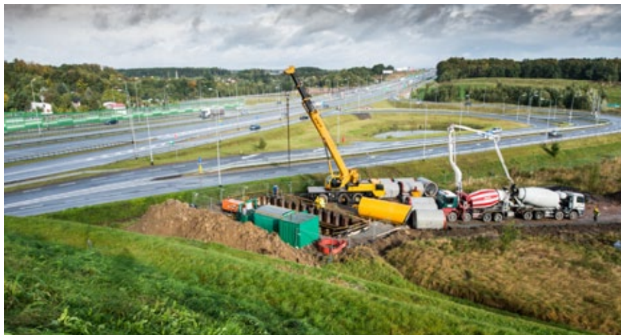
Ograniczenie niskiej emisji poprzez likwidację lokalnego źródła węglowego oraz budowa magistrali ciepłowniczej w Gdańsku (fot. Grupa GPEC Sp. z o. o.)
