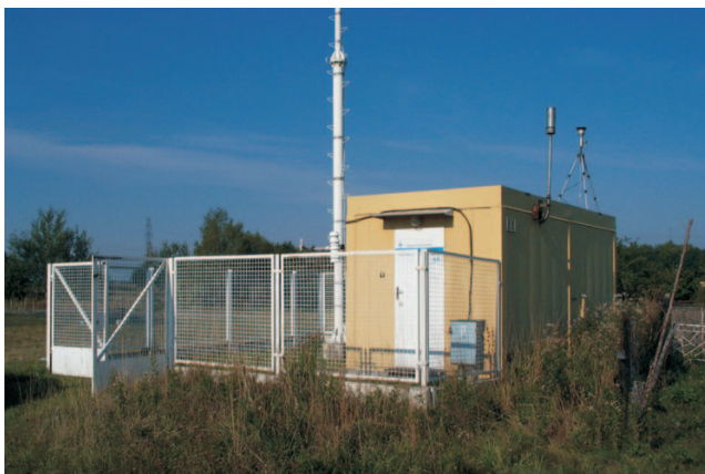
Fot. 1. Automatyczna stacja pomiarowa kontener
