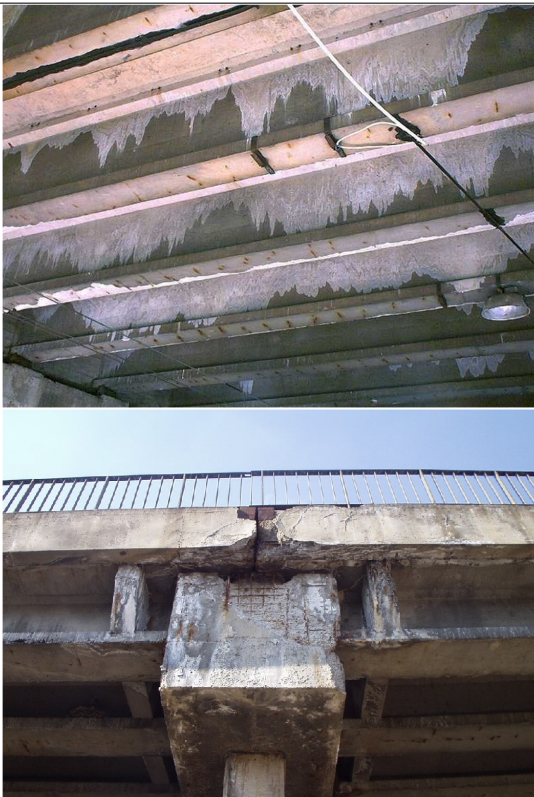
Rys.32. Korozja ługująca i uszkodzenie spowodowane przeciekami w dylatacji
