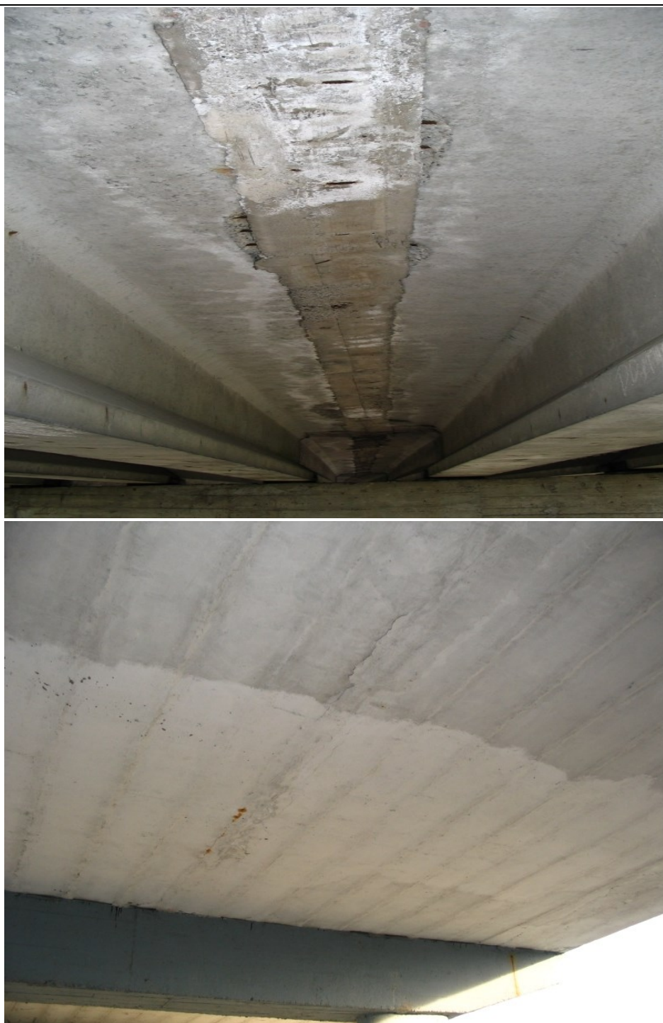
Rys.33. Uszkodzenie styków podłużnych i klawiszowanie się belek
