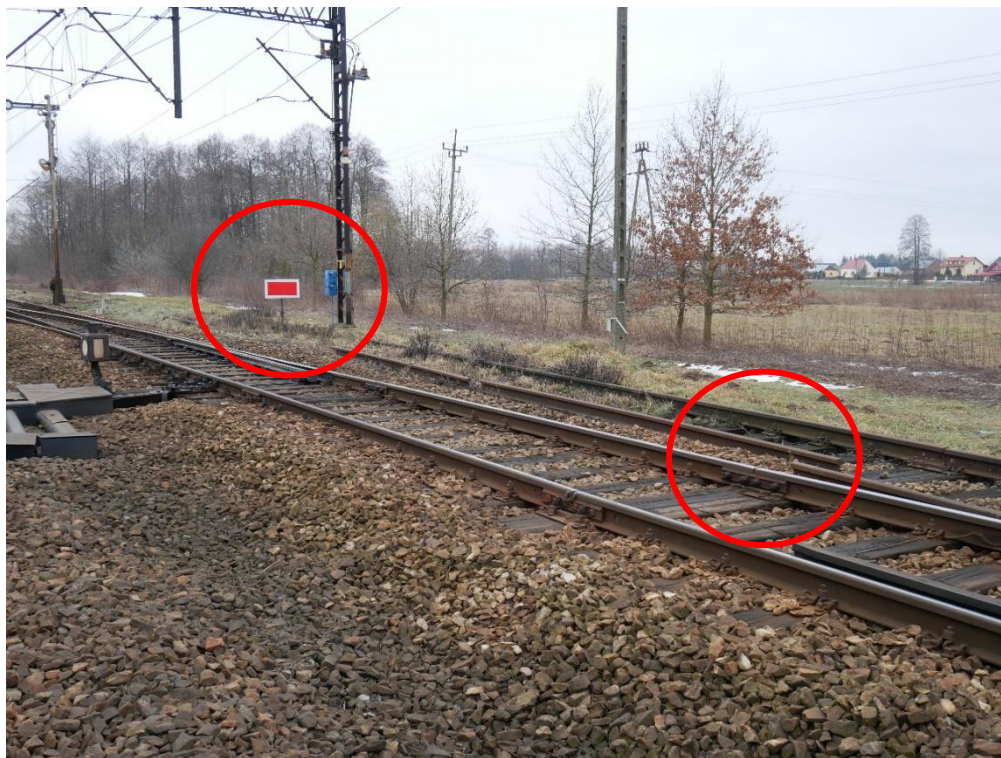
Zdjęcie 6 – Zamknięty tor 3. i brak ciągłości toku toru 3. za krzyżownicą rozjazdu nr 3
