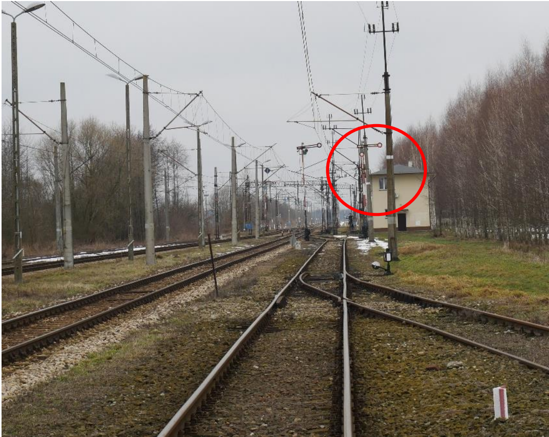
Zdjęcie 5 – Widok słupa przesyłającego sygnał nocny semafora D (fot. PKBWK)
