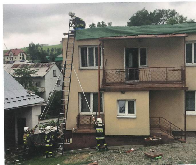
Działania ratownicze strażaków PSP i OSP przy zabezpieczaniu uszkodzonych budynków
