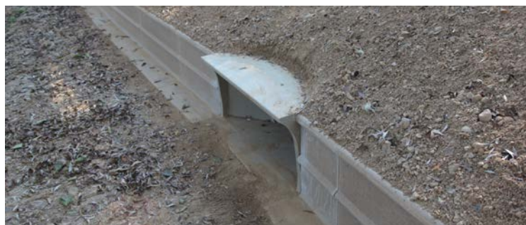
System przepustów dla płazów w miejscowości Baciuty, fot. L. Krzysztofiak
