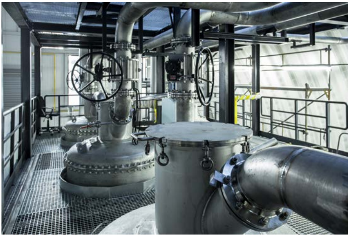
Instalacja demonstracyjna LIFEcogeneration.pl: węzeł oczyszczania syngazu, fot. Investeko S.A.
