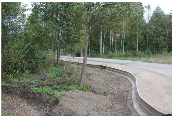
System przepustów dla płazów w miejscowości Krzywe, fot. L. Krzysztofiak
