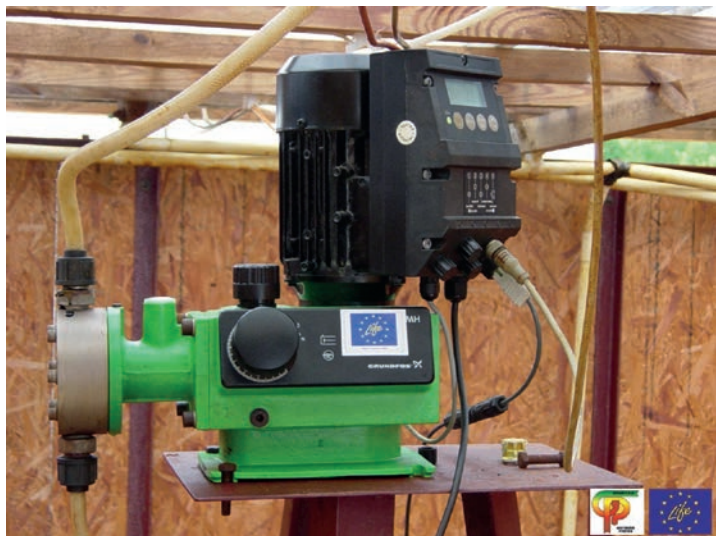
Pompa dozująca kwas solny, fot. Geotermia Pyrzyce
