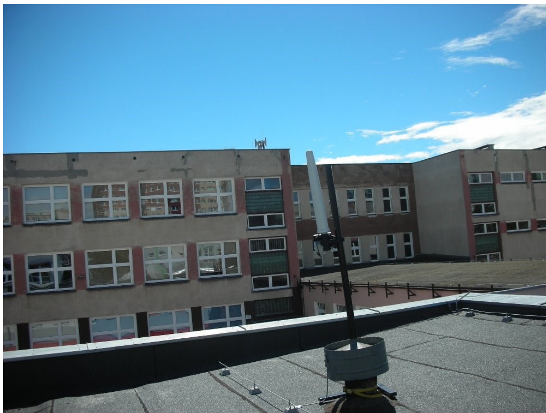
Rys. 2 Miejsce montażu SMS PEM – Szkoła Podstawowa nr 6 w Pile
