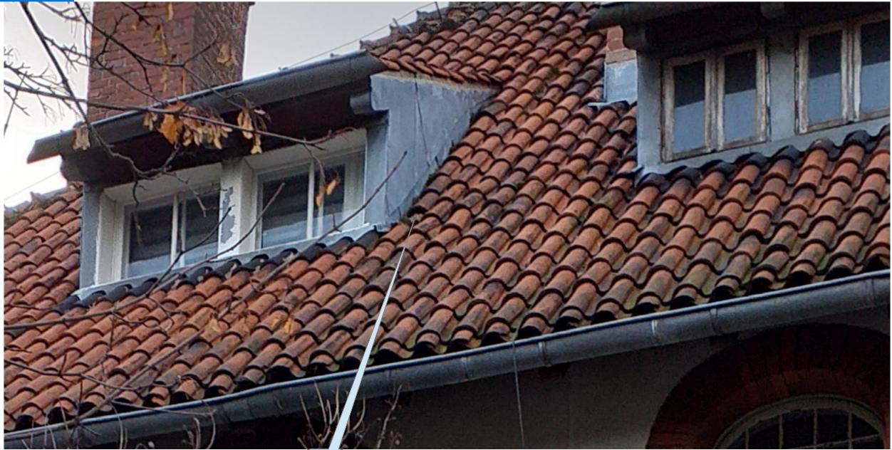
Dziura w dachu - brak dachówki
