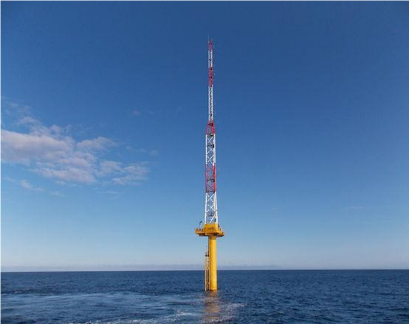
Rysunek 8. Przykładowe zdjęcie masztu pomiarowego (Powerpoint)
